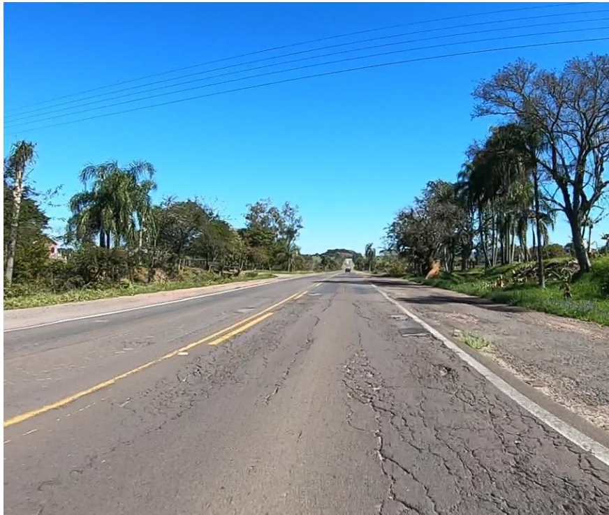
Defeitos diversos – captura de imagem extraída de vídeo-registro da rodovia realizado em 31/08/2021
