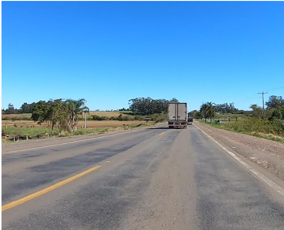
Afundamento de trilha de roda – captura de imagem extraída de vídeo-registro da rodovia realizado em 31/08/2021
