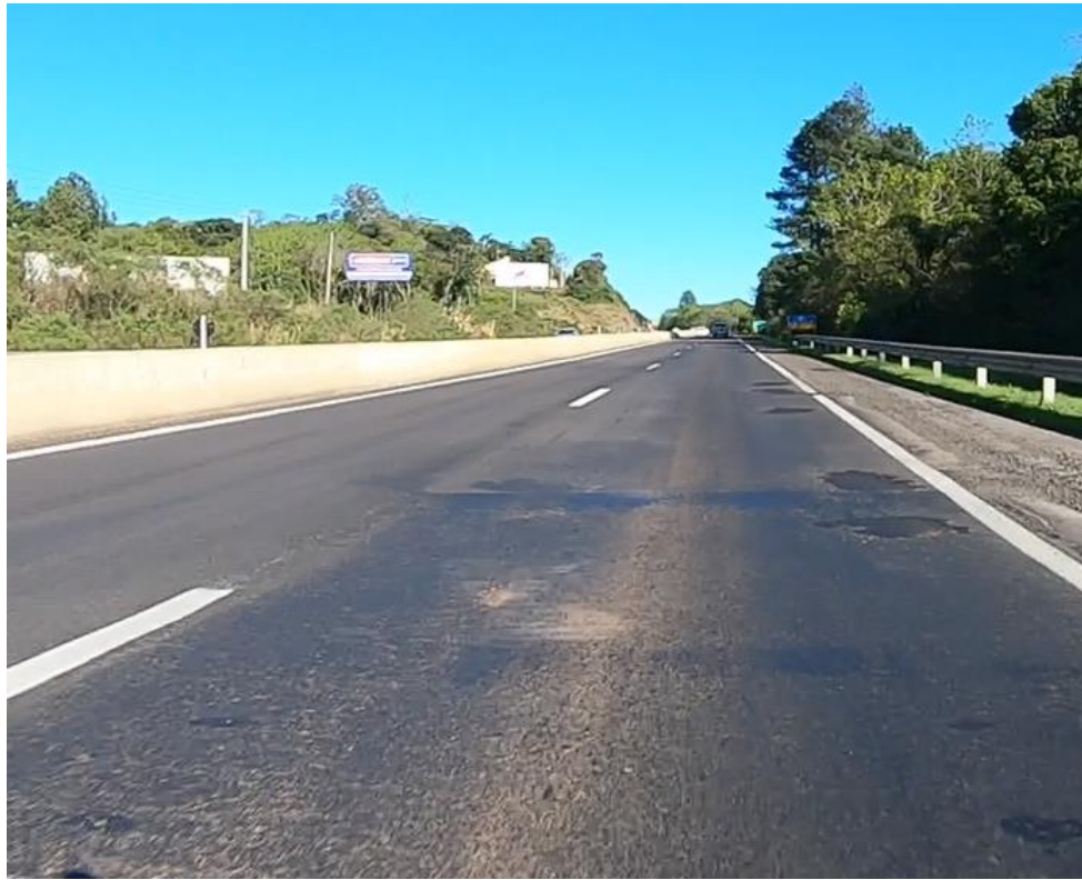
Deformações plásticas e painelas – captura de imagem extraída de vídeo-registro da rodovia realizado em 31/08/2021
