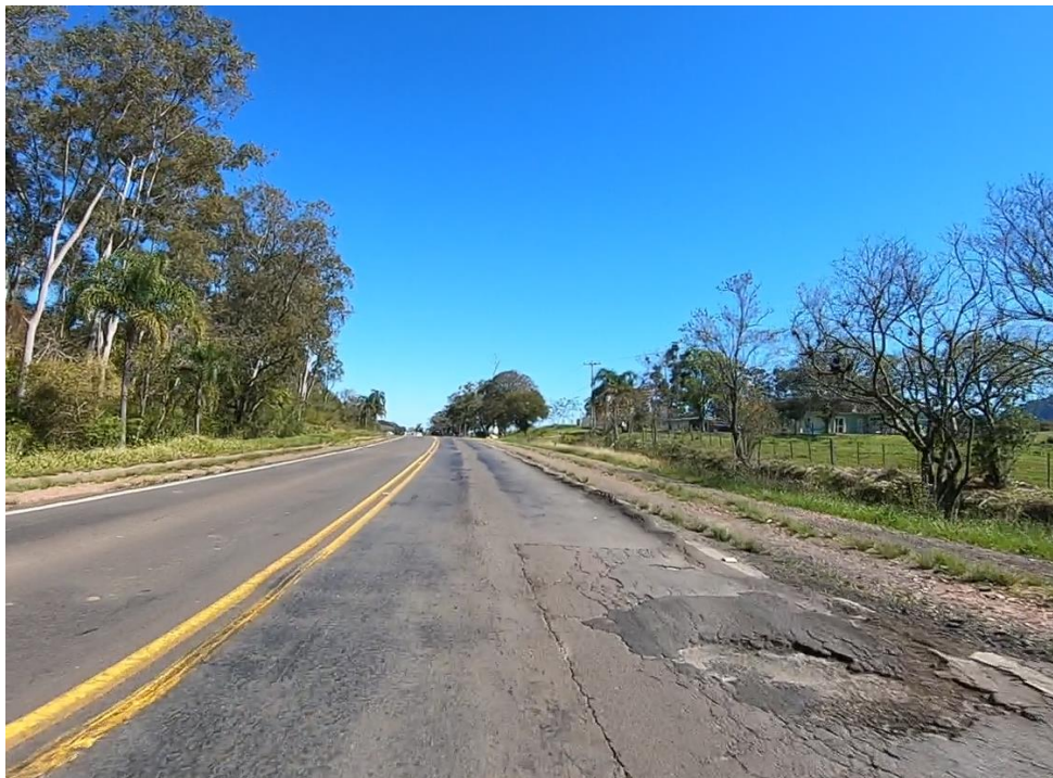
Defeitos diversos – captura de imagem extraída de vídeo-registro da rodovia realizado em 31/08/2021
