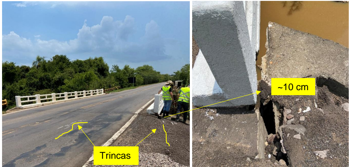
Figura 16 - Foto de movimentação estrutural da ala (e talude) do encontro com a ponte.
