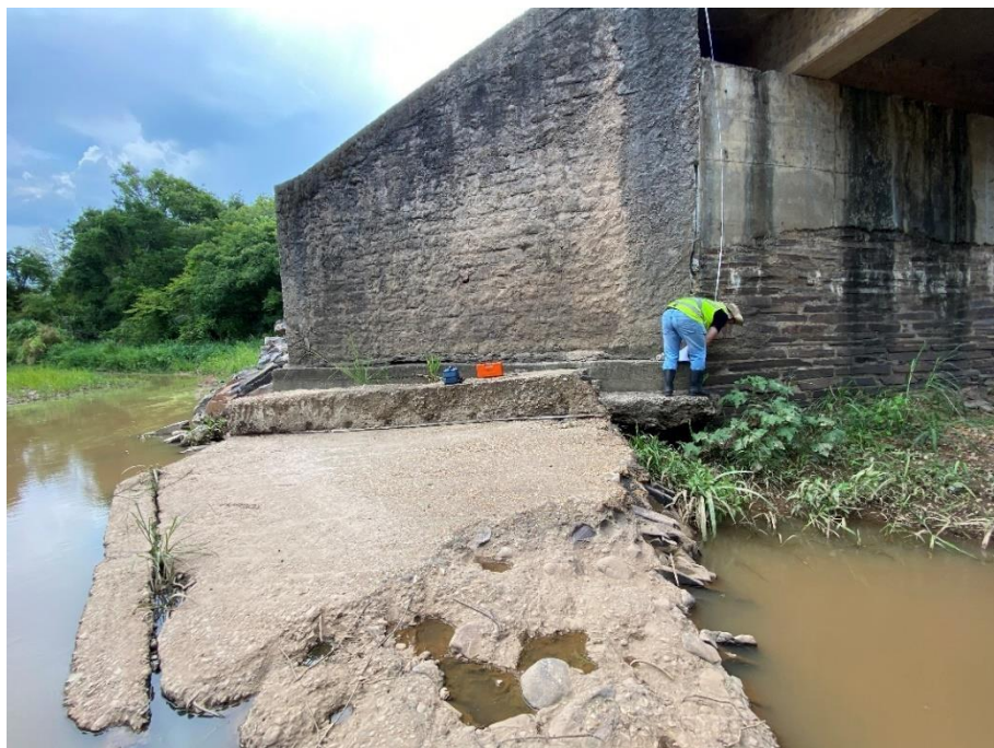
Figura 7 - Foto da ala da ponte que está em processo de tombamento.
