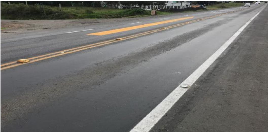
Trecho com intervenção da antiga administradora em fevereiro/2021 (km 29+490), apresentando Exsudação
