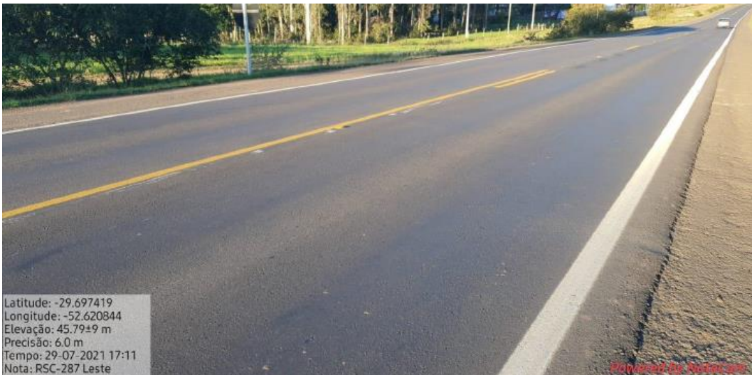
Trecho com intervenção da antiga administradora em março/2021 (km 121+000), apresentando Exsudação
