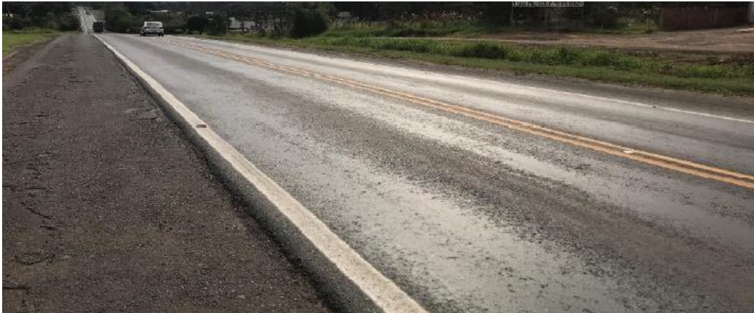
Trecho com intervenção da antiga administradora em fevereiro/2021 (km 28+950), apresentando Exsudação
