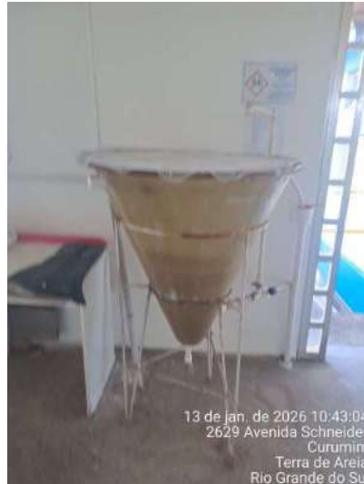
Figura 9 - Equipamentos obsoleto de dosagem de fluoreto
