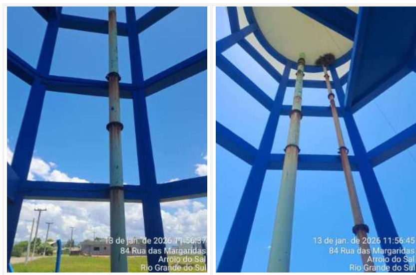
Figura 17 - Tubulações do Reservatório R2
