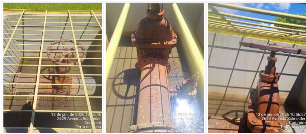
Figura 12 - Registro com vazamento
