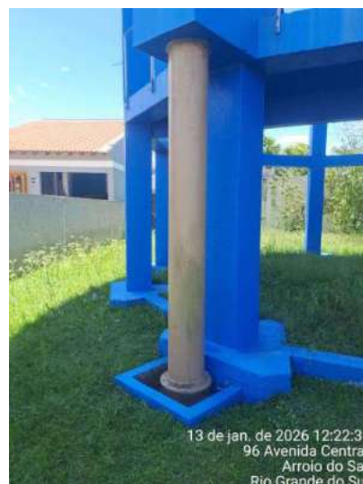
Figura 19 - Extravasador do Reservatório R3 sem dispositivo limitador de poeira
