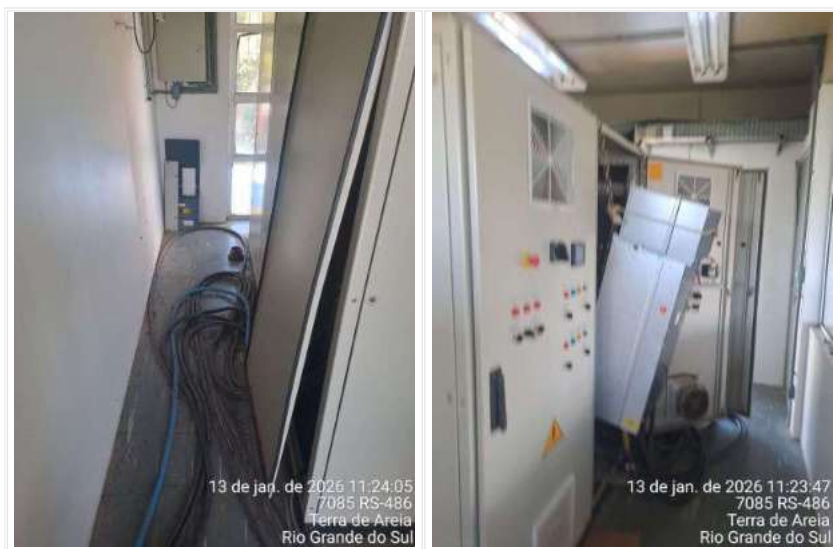
Figura 4 - Painéis e cabos elétricos da sala de bombas da Captação Curumim
