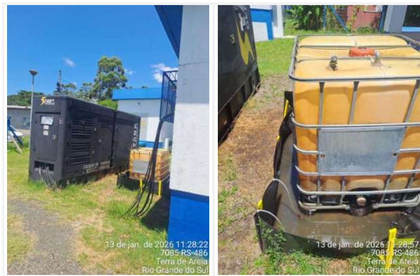
Figura 6 - Bacia de contenção com acúmulo de líquido
