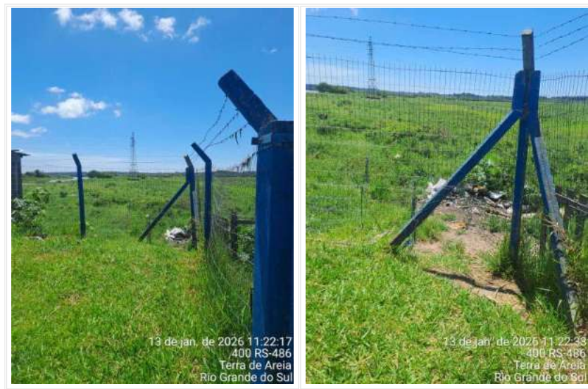
Figura 1 - Cerca da Captação Curumim em condições inadequadas
