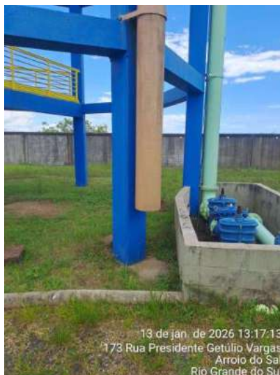
Figura 22 - Extravasor do Reservatório R4 sem dispositivo limitador de poeira
