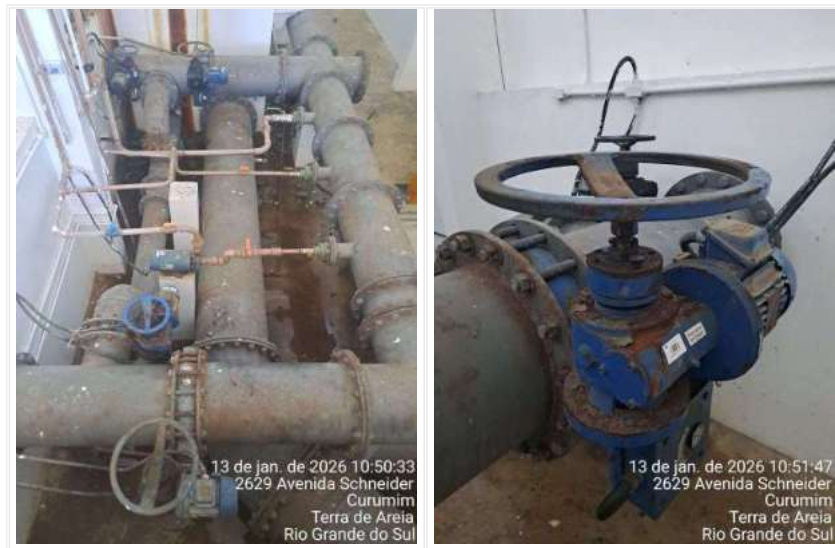
Figura 7 - Válvula/registro em condições inadequadas de conservação e manutenção
