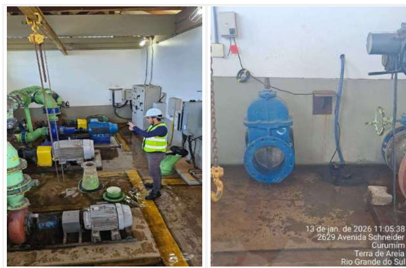
Figura 10 - Sala de bombas alagada
