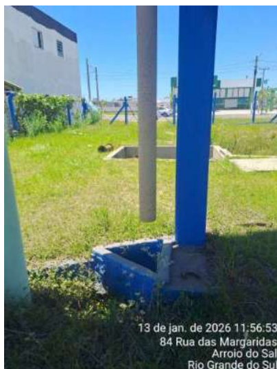
Figura 15 - Extravasor do Reservatório R2 sem dispositivo limitador de poeira
