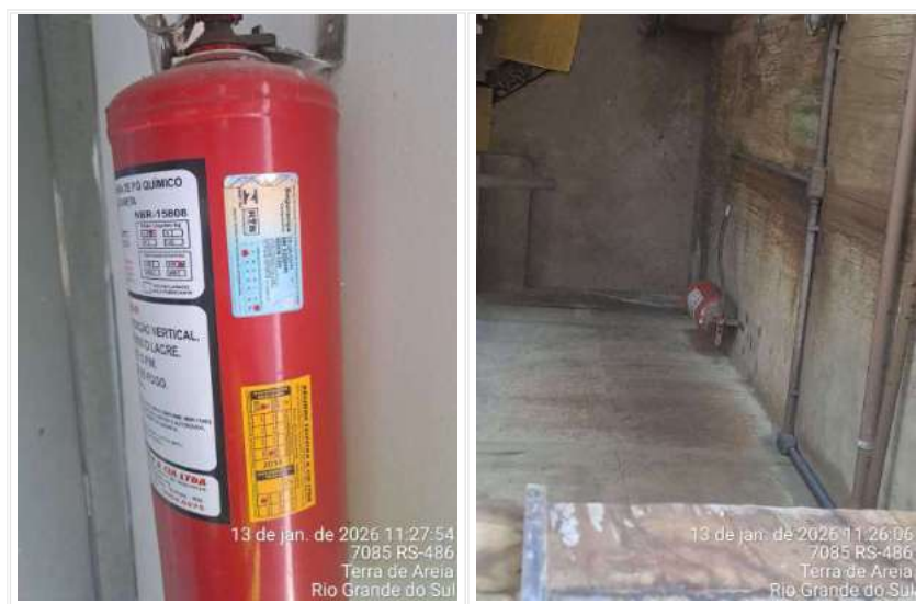
Figura 5 - Extintores com manutenção vencida e posicionamento inadequado
