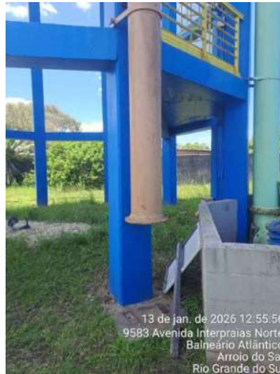
Figura 21 - Extravasor do Reservatório R5 sem dispositivo limitador de poeira
