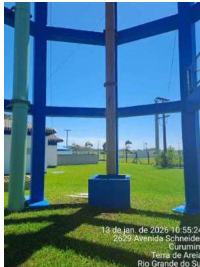
Figura 11 - Extravasador do Reservatório R1 sem dispositivo limitador de poeira
