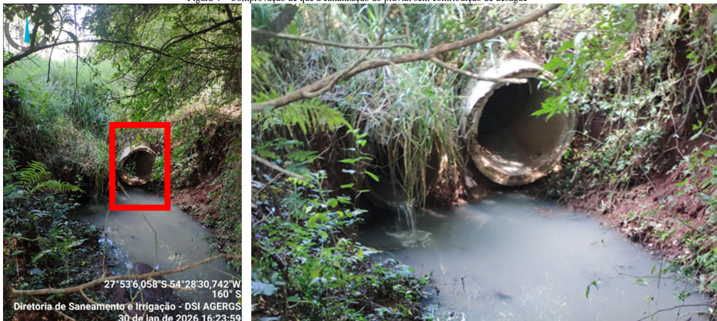
Figura 4 – Comprovação de que a canalização do pluvial sem contribuição de desag
