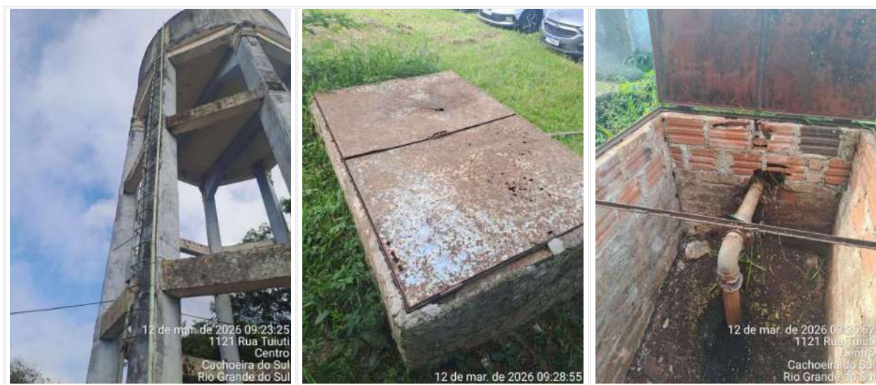
Figura 26 - Tubulação e caixa de manobras do R11
