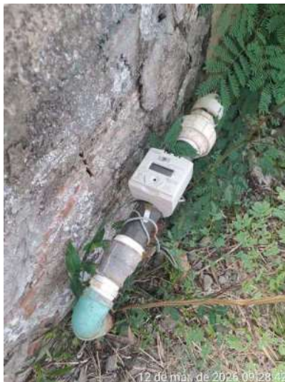
Figura 24 - Macromedidor do Reservatório R11 fora de operação
