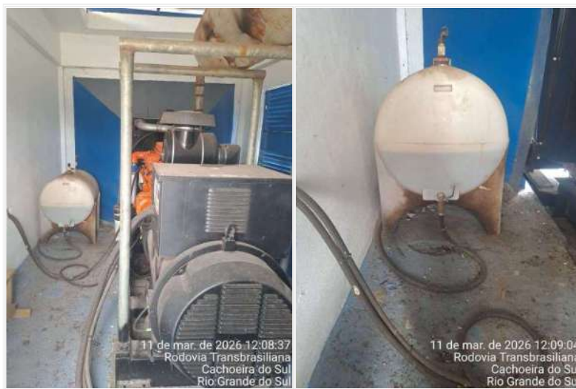
Figura 8 - Tanque de combustível do gerador
