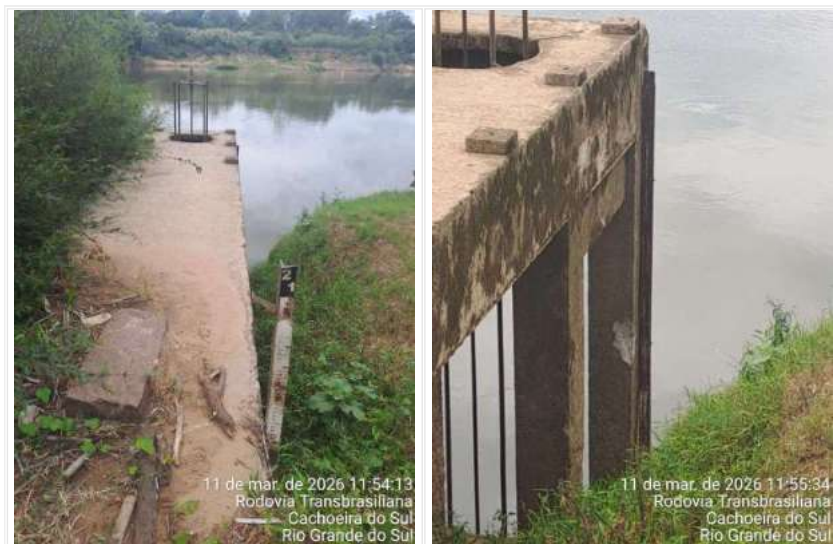
Figura 5 - Condições inseguras no local de Captação
