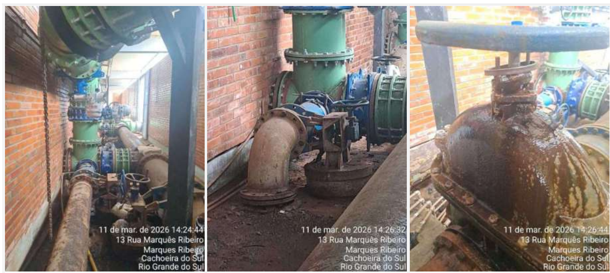
Figura 9 - Equipamentos da galeria de filtros em condições inadequadas de operação
