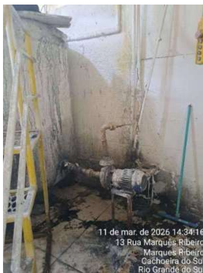
Figura 13 - Conjunto motor bomba de carvão ativado
