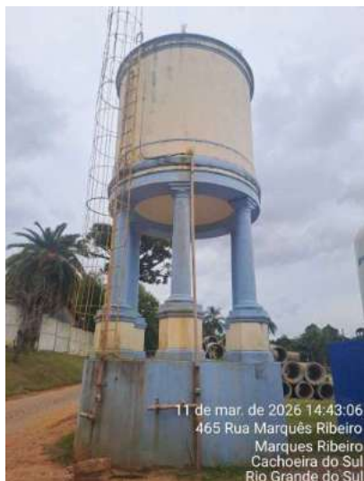
Figura 11 - Reservatório de sulfato de alumínio
