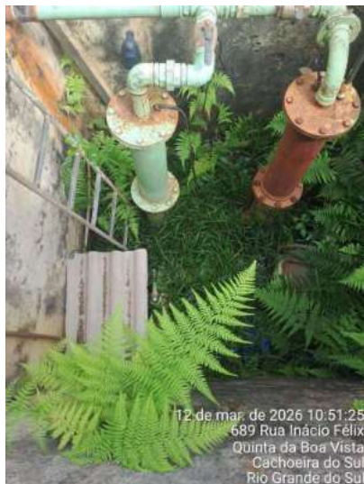
Figura 30 - Caixa de manobras do R7
