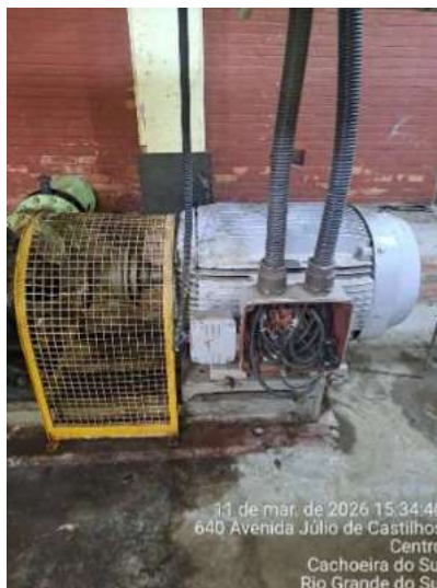
Figura 19 - Condições inseguras no motor
