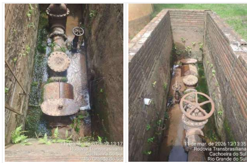
Figura 6 - Registros com vazamentos e caixa de manobras
