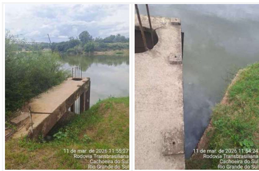
Figura 4 - Condições inseguras no local de Captação
