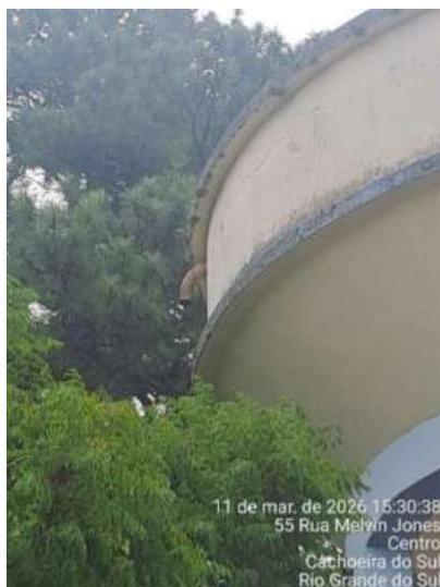
Figura 21 - Extravasor do Reservatório R3 sem dispositivo limitador de poeira
