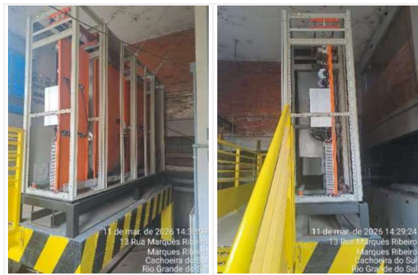
Figura 16 - Painéis elétricos abertos
