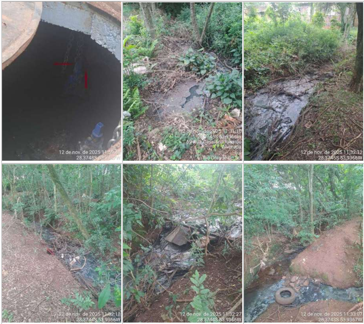
Figura 19 - Extravasamento de esgoto da EBE 13B
