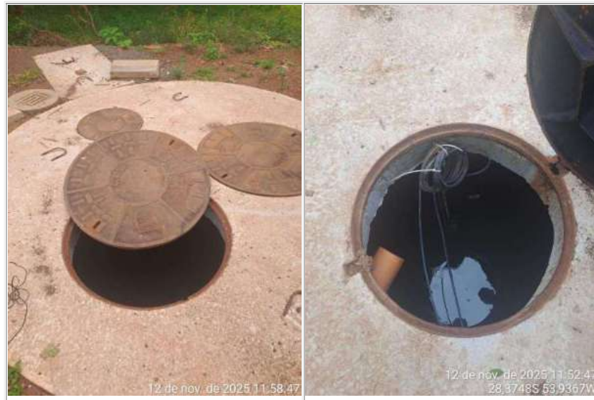
Figura 18 - Poço e instalações da EBE 13B
