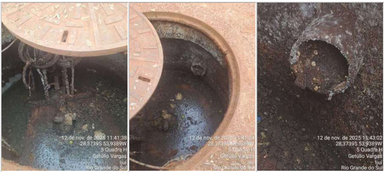
Figura 14 - Poço e instalações da EBE 13C
