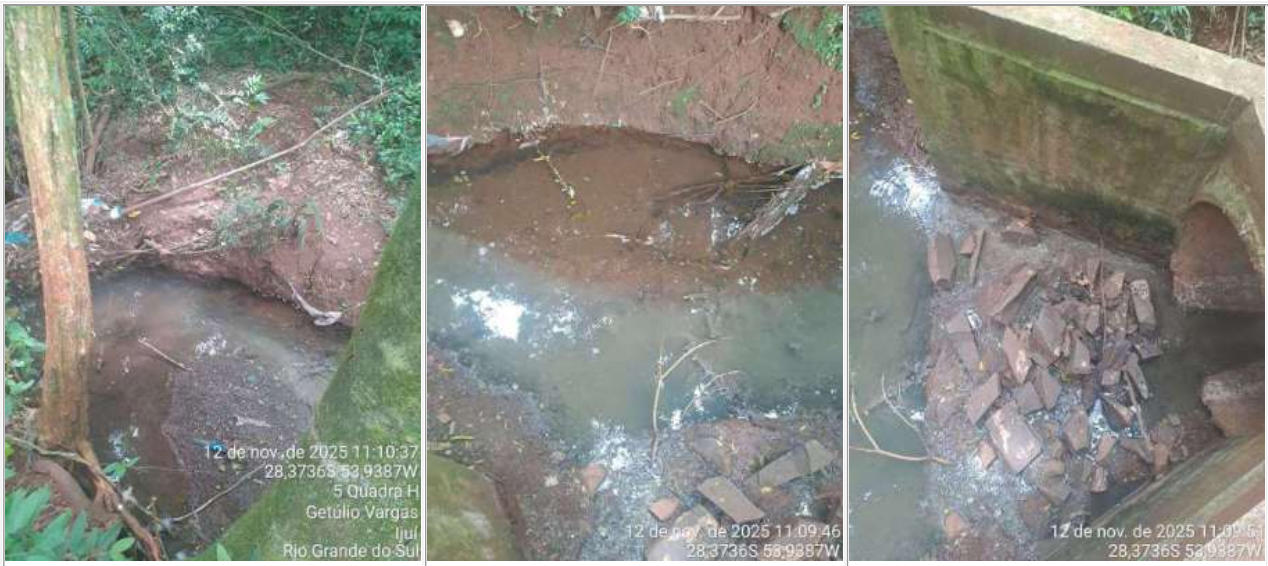
Figura 16 - Lançamento de efluente bruto em corpo hídrico
