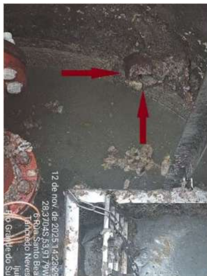
Figura 20 - Poço da EBE Tancredo Neves com acúmulo de resíduos no extravasor
