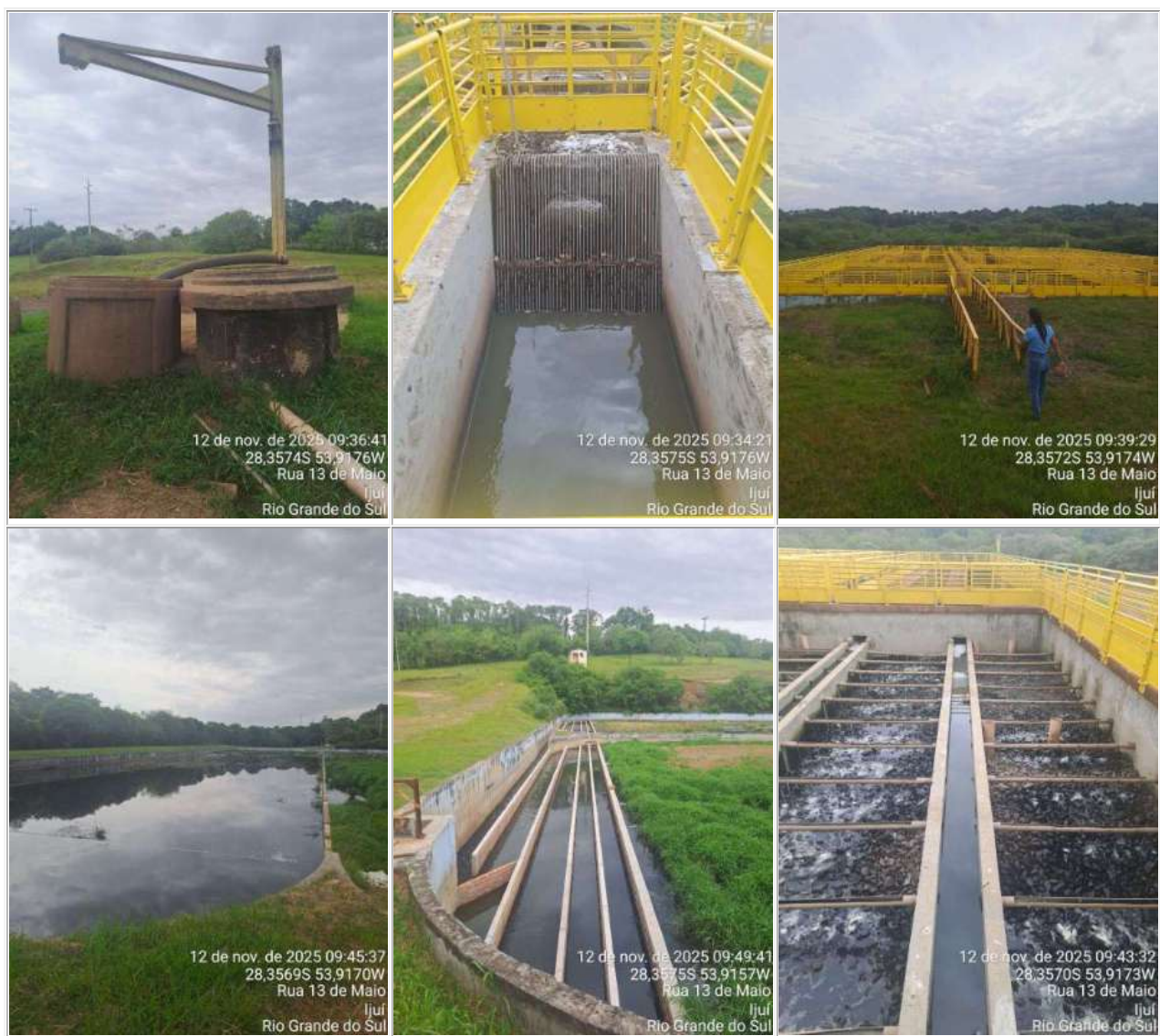
Figura 3 - Unidades de tratamento da ETE sem placas de identificação
