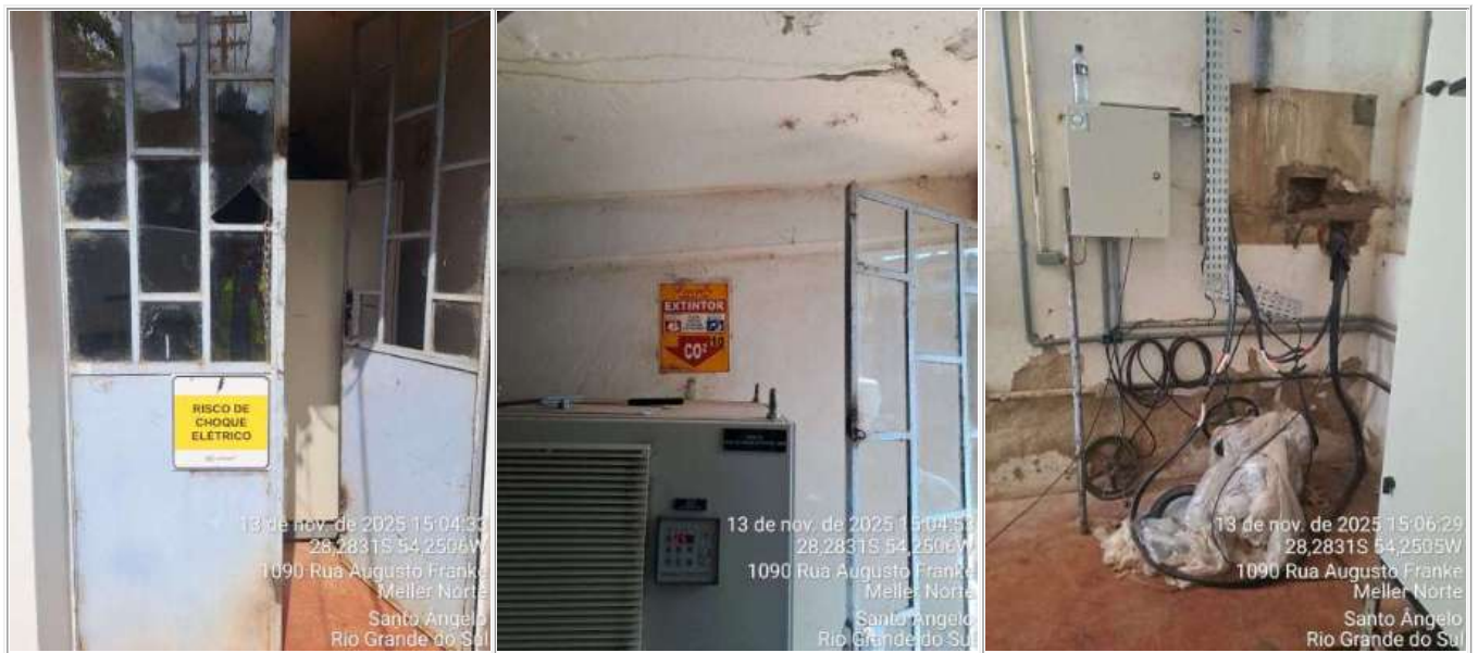
Figura 9 - Instalações da sala de bombas da Captação do Rio Itaquerintim.
