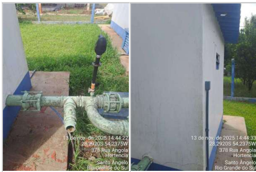
Figura 19 - Sistema de recalque do Booster do Presídio
