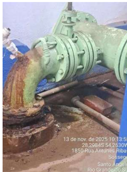
Figura 10 - Tubulação da galeria de filtros.
