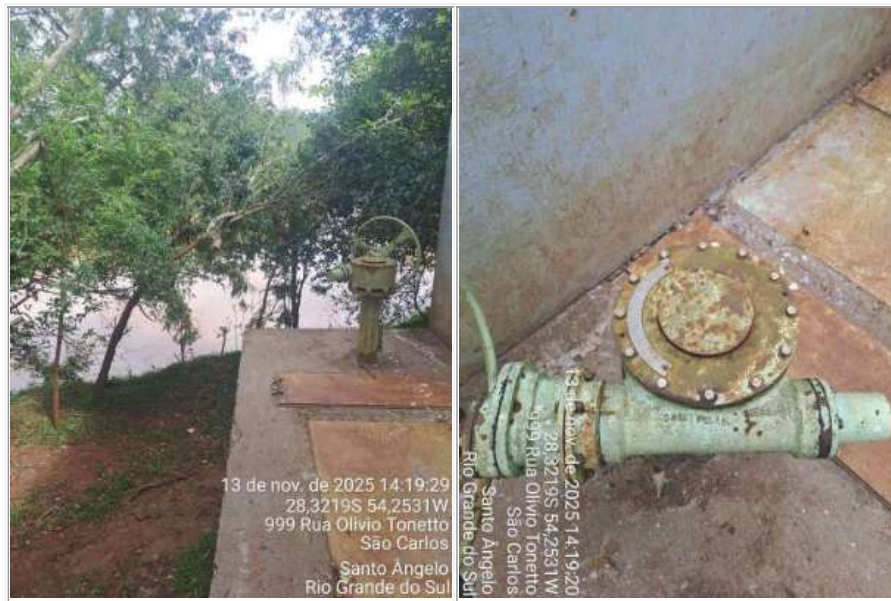
Figura 4 - Válvula do poço de Captação do Rio Ijuí.
