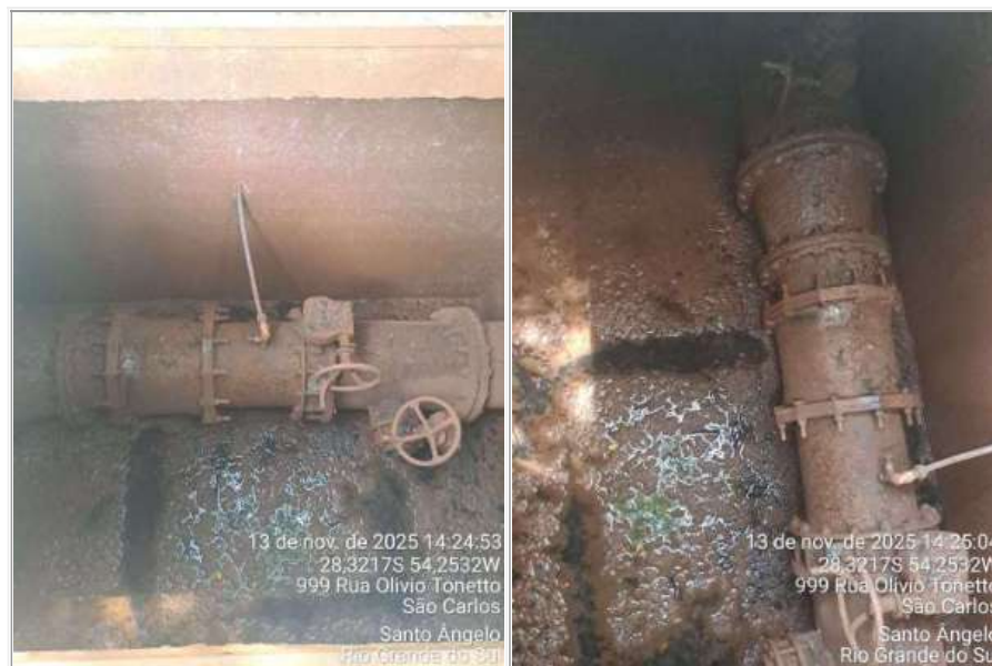
Figura 6 - Caixa da adutora de água bruta com acúmulo de lodo.
