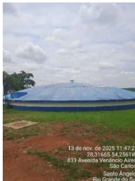
Figura 22 - Reservatório Semienterrado da ETA II
