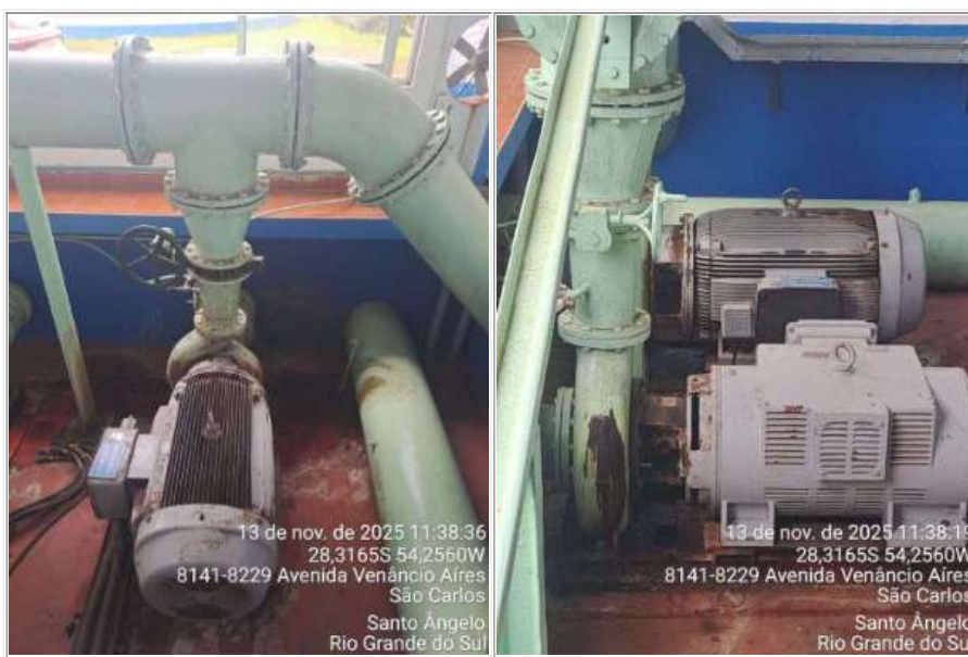
Figura 17 - Conjunto motobomba do Recalque da ETA II
