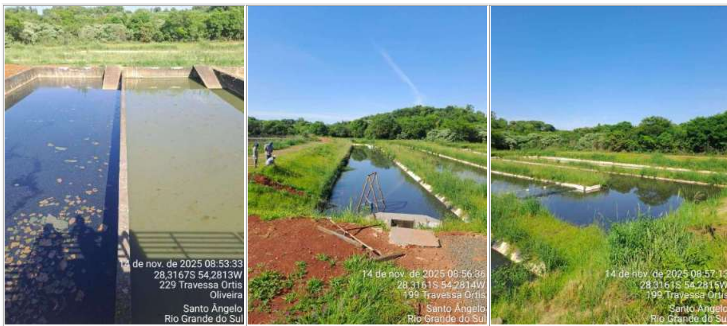
Figura 2 - Lagoas de tratamento
