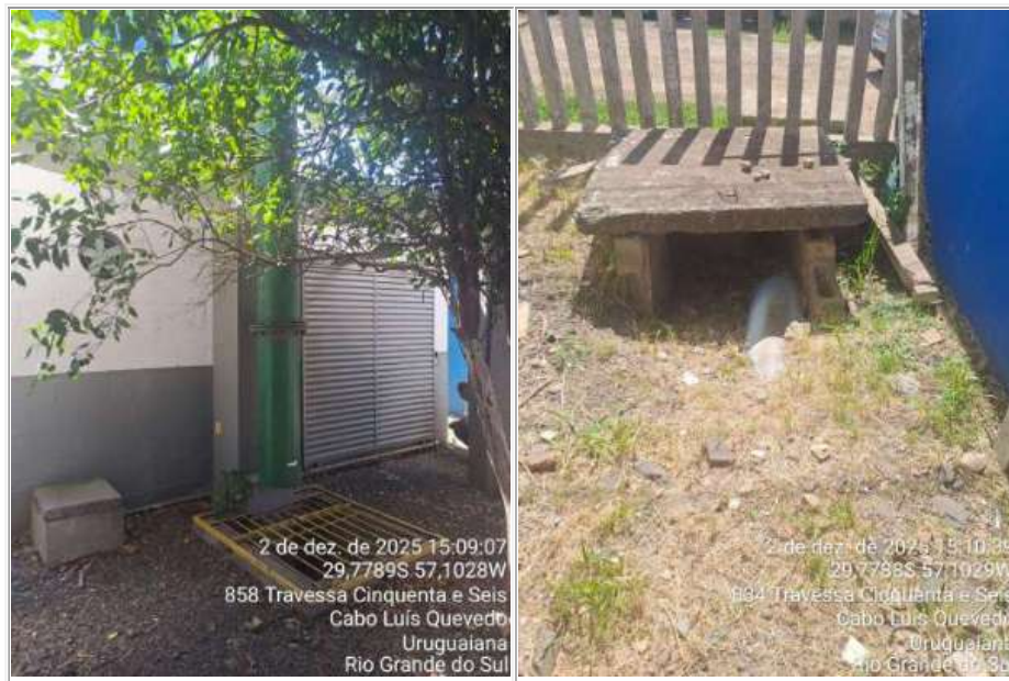
Figura 12 - Extravasor dos Reservatórios Cabo Luiz Quevedo
