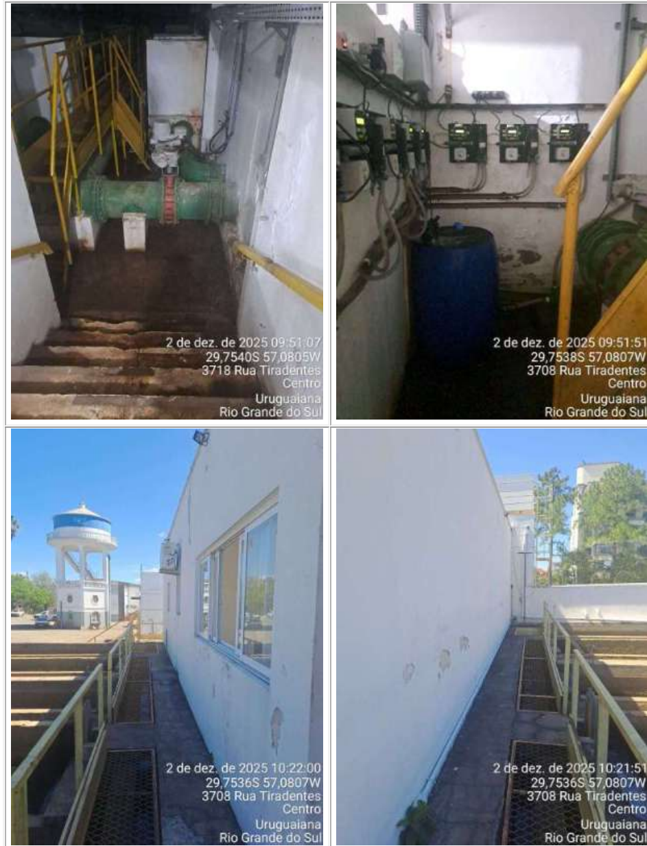
Figura 06 - Galeria e salão de filtros em condições inadequadas de conservação.
