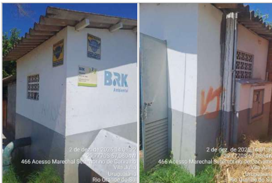
Figura 08 - Abrigo do Booster Flores da Cunha com sinais de vandalismo.
