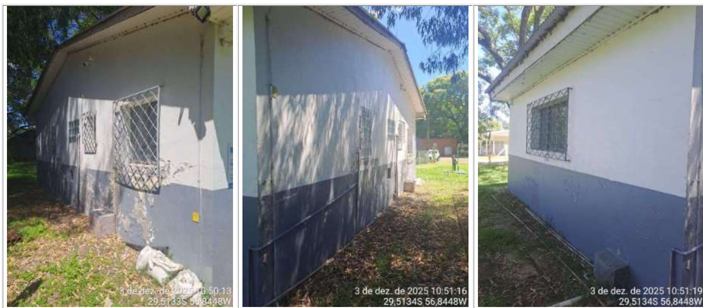
Figura 02 - Abrigo do Poço da Captação São Marcos em condições inadequadas de conservação.
