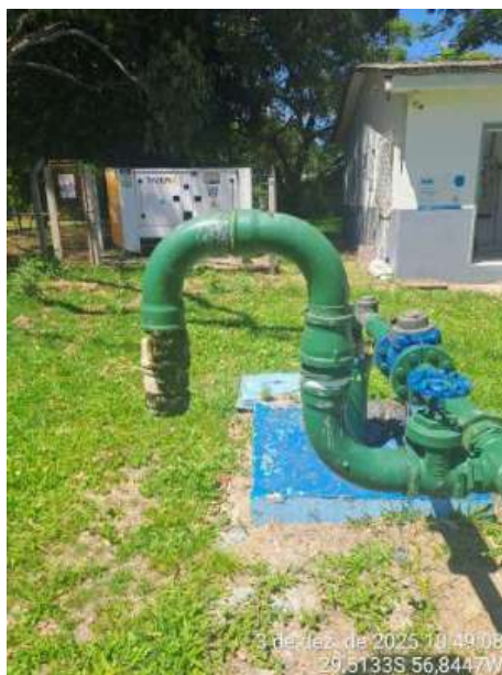
Figura 01 - Poço da Captação São Marcos com acúmulo de lodo.
