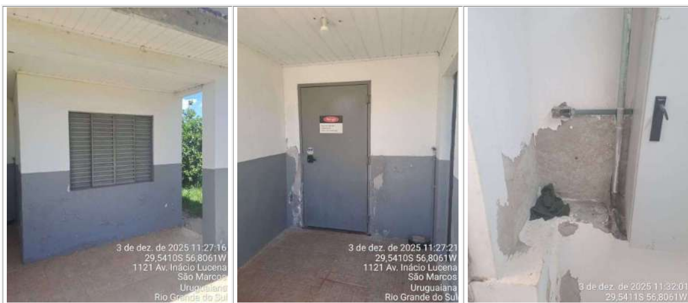
Figura 04 - Abrigo do Poço da Captação Barragem Sanchuri em condições inadequadas de conservação.
