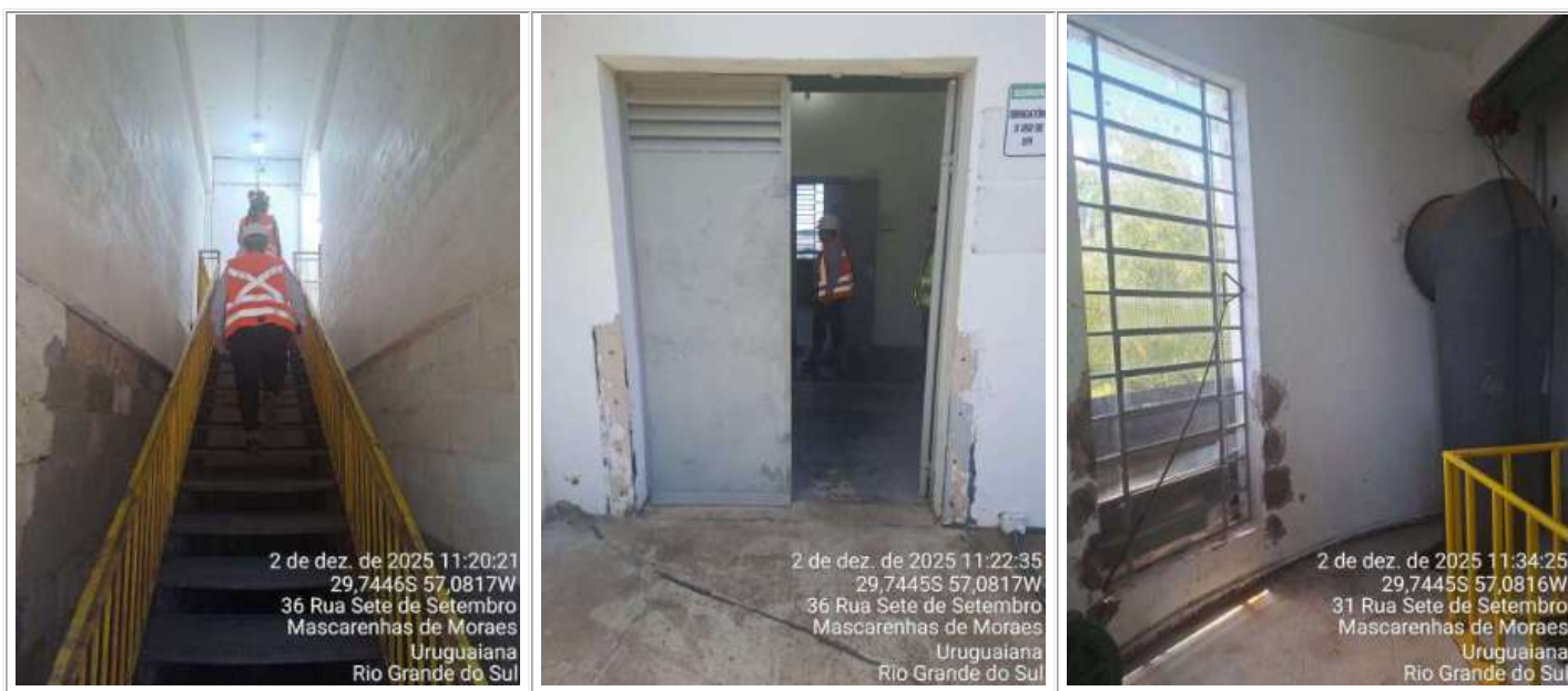
Figura 05 - Estruturas da sala de bombas Captação Rio Uruguai em condições inadequadas de conservação.
