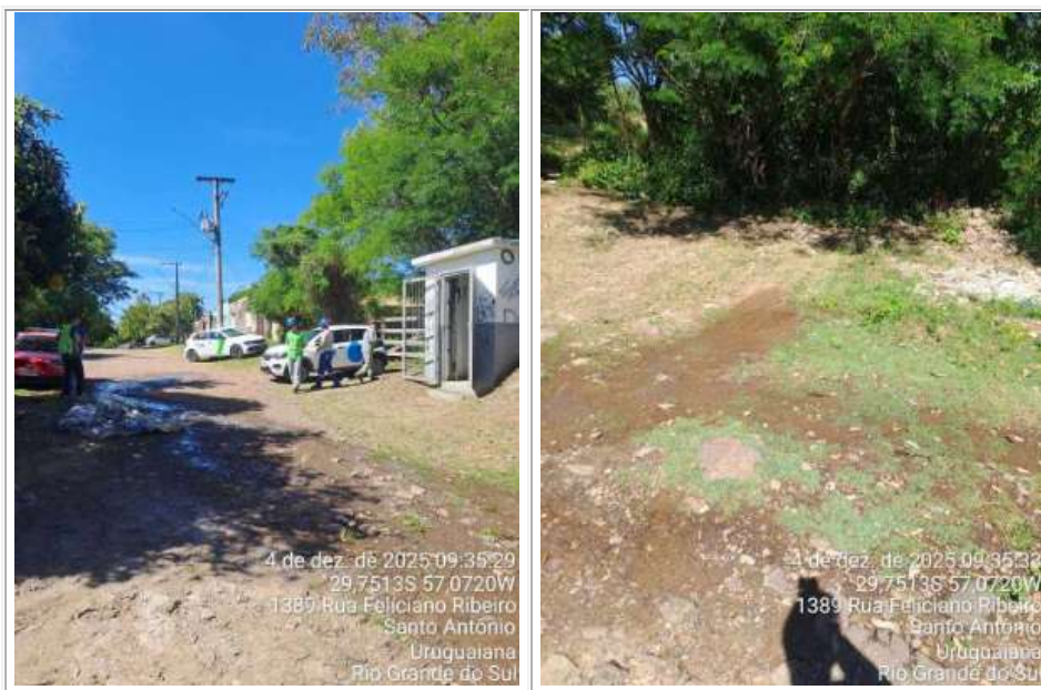
Figura 6 - Afloração de esgoto em via pública nas proximidades da EEEB 06
