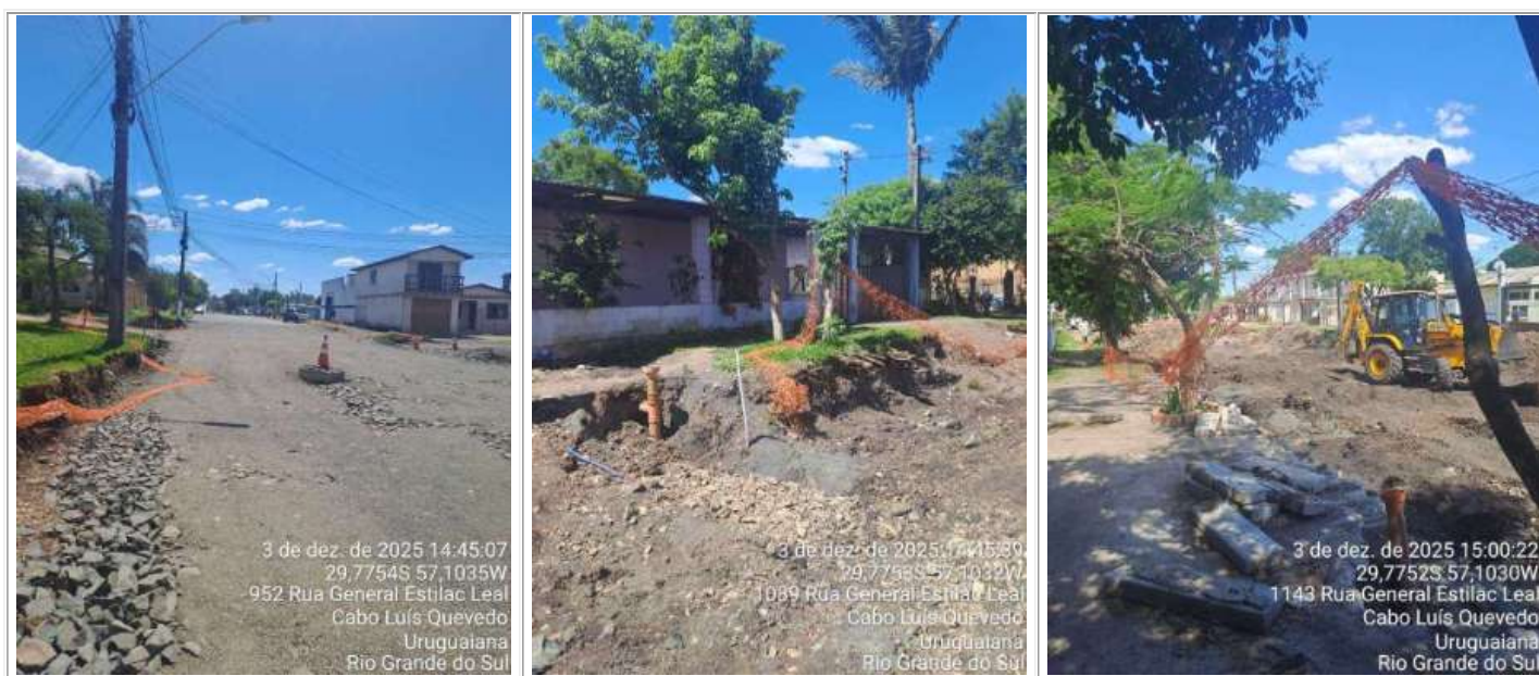
Figura 5 - Isolamento inadequado nos locais das obras
