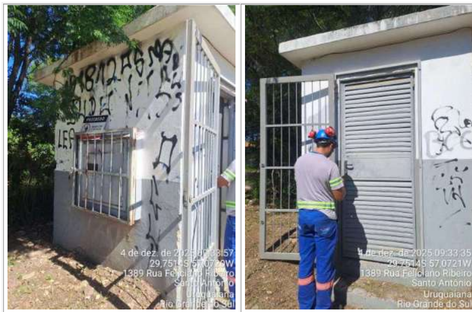
Figura 1 - Abrigo dos painéis da EEEB 06
