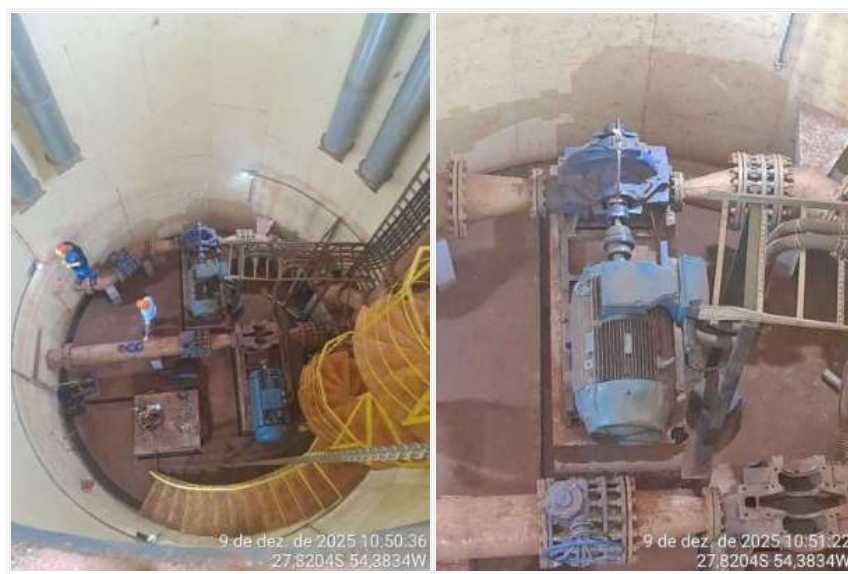
Figura 3 - Sistema de bombeamento sem proteção das partes móveis
