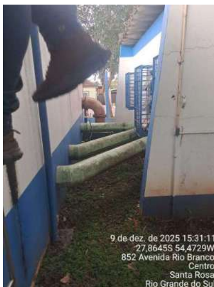
Figura 30 - Extravasador do Reservatório R2B sem dispositivo limitador de poeira
