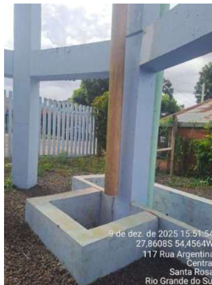
Figura 32 - Extravasor do Reservatório R4 sem dispositivo limitador de poeira
