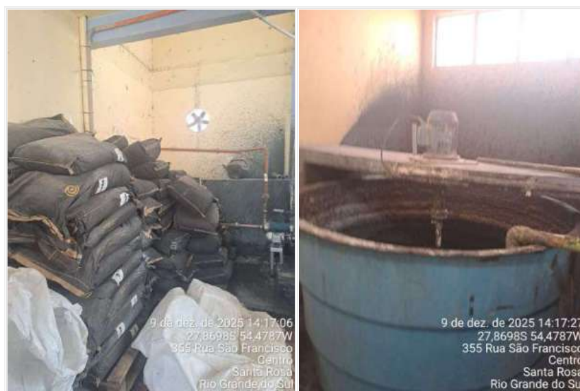
Figura 21 - Casa de química com indícios de derramamentos
