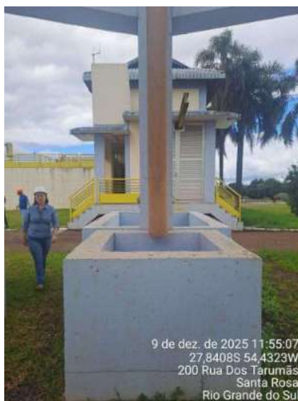
Figura 27 - Extravasor do Reservatório elevado sem dispositivo limitador de poeira
