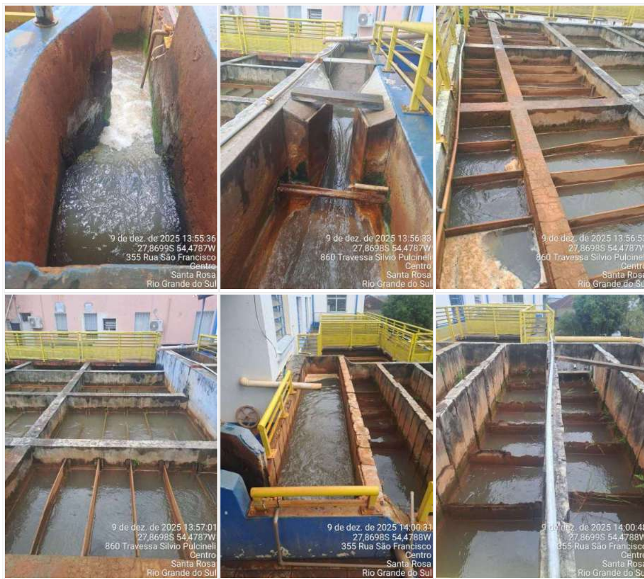
Figura 19 - Unidades de tratamento em condições inadequadas de conservação, operação e manutenção
