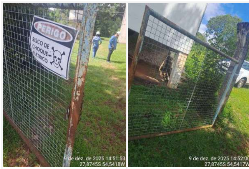
Figura 5 - Portão em condições ruins de conservação
