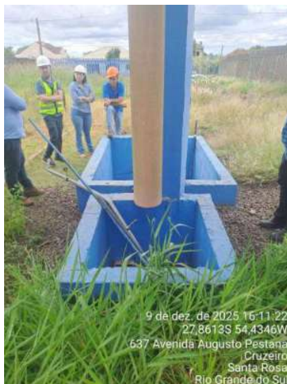
Figura 32 - Extravasor do Reservatório R5 sem dispositivo limitador de poeira
