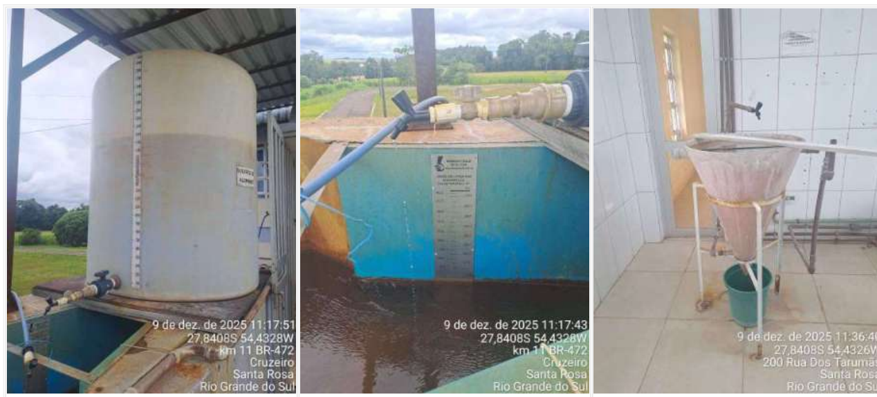
Figura 15 - Dosagem de produtos químicos na ETA II
