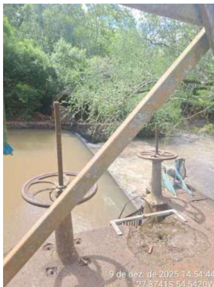
Figura 7 - Equipamentos em condições inadequadas de manutenção
