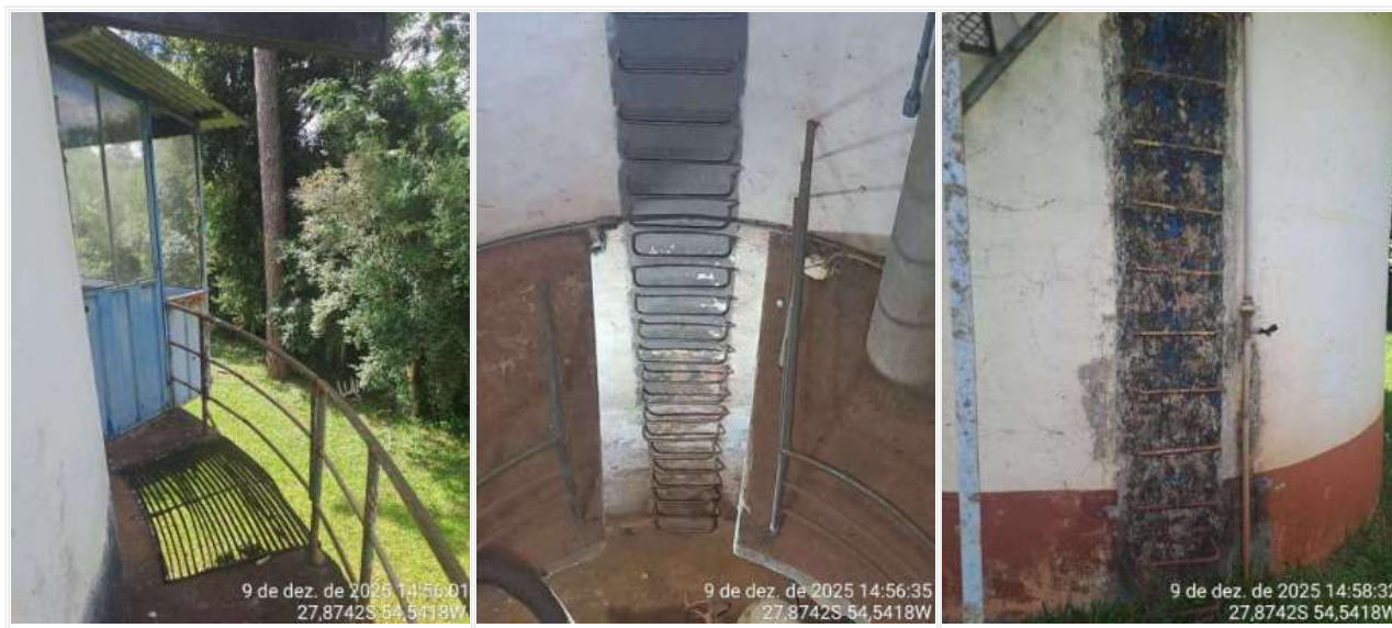
Figura 9 - Dispositivos de segurança em condições inadequadas de conservação e manutenção
