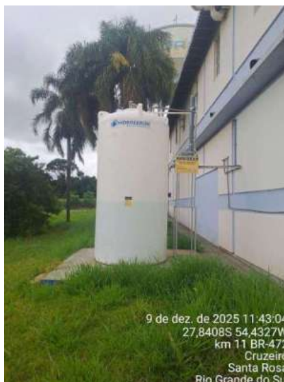
Figura 14 - Tanque de hipoclorito da ETA II
