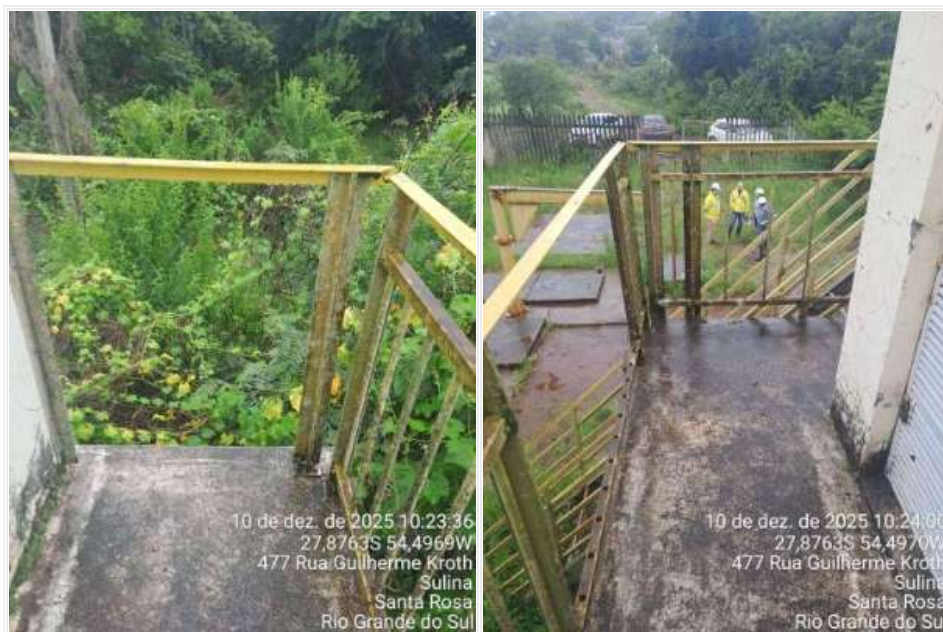
Figura 8 - Guarda-corpo em condições inadequadas de conservação
