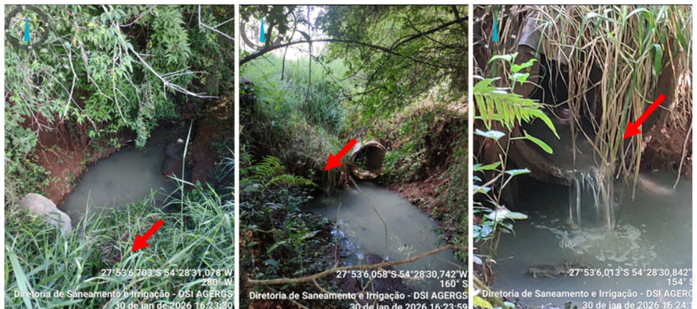
Figura 1 – Extravasamento de esgoto na EBE Bela Vista em 30/01/2026 (data da fiscalização)
