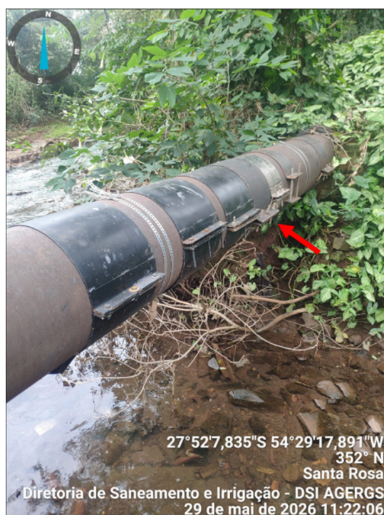
Figura 3 – Pequeno gotejamento de esgoto no Emissário na Rua Boa Vista, em 29/05/2026 (verificação posterior)
