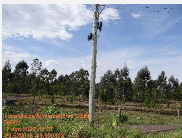
Poste de madeira com rachaduras.
