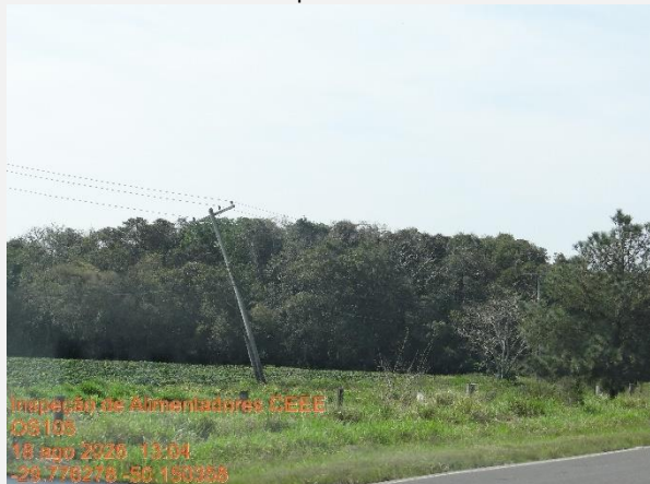
Postes de madeira fora de prumo e com escora de madeira.
