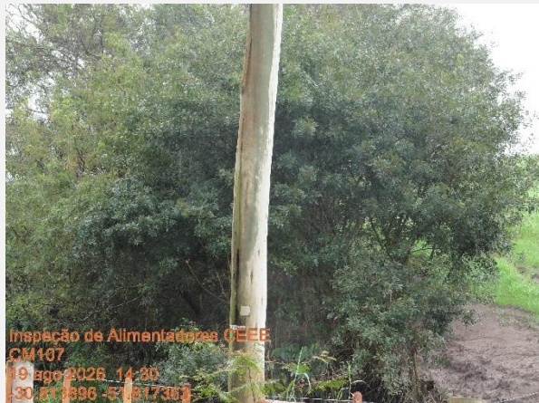
Poste de madeira com rachaduras severas.
