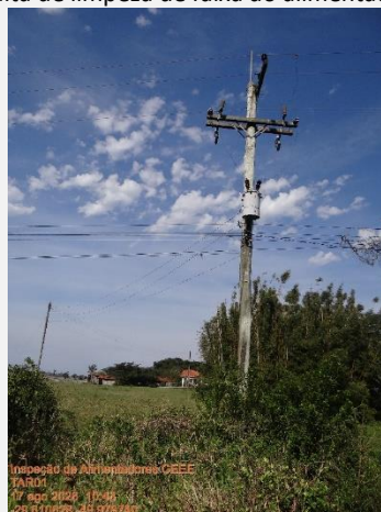
Falta de limpeza de faixa do alimentador.
