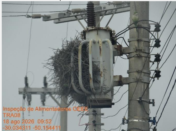
Ninho de pássaro em transformador BT.
