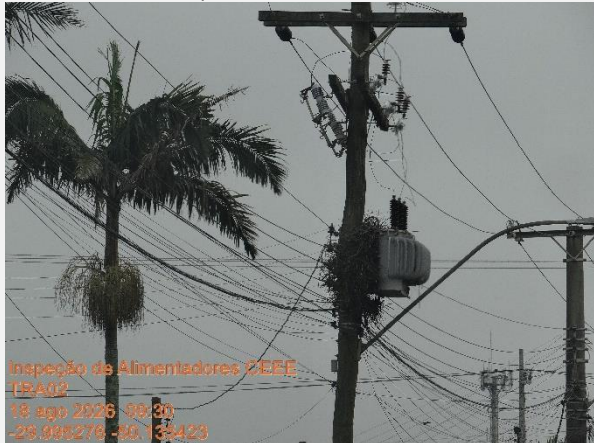
Ninho de pássaro em transformador BT.
