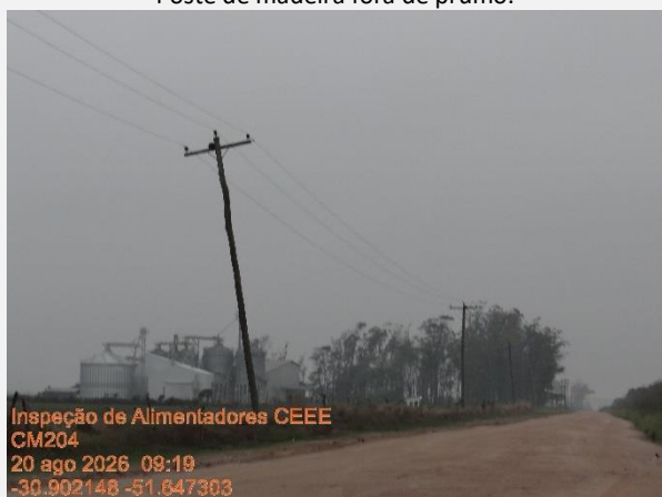
Poste de madeira fora de prumo.
