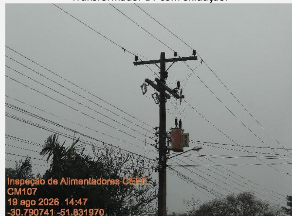
Transformador BT com oxidação.
