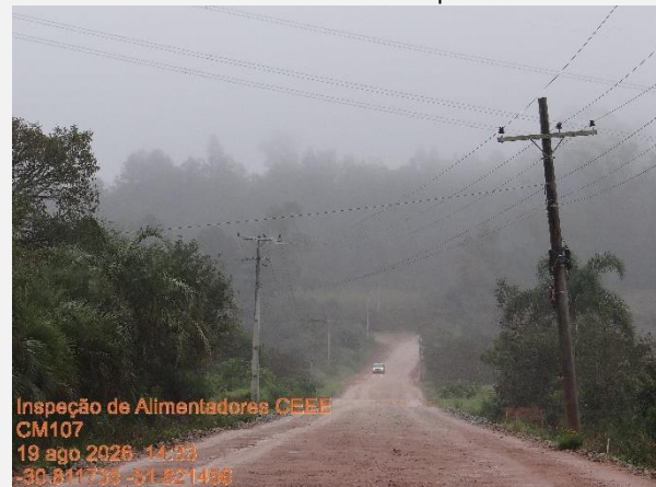
Poste de concreto fora de prumo.
