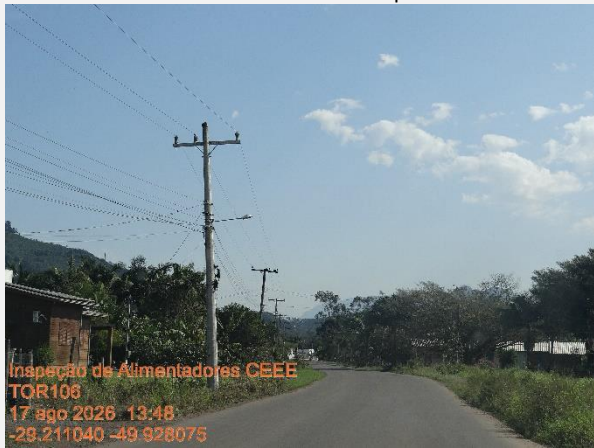
Poste de concreto fora de prumo.
