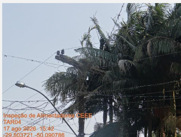
Poste de madeira tomado por vegetação e cabos do alimentador próximos a árvores.
