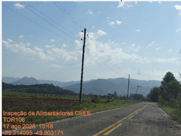
Postes de madeira fora de prumo.
