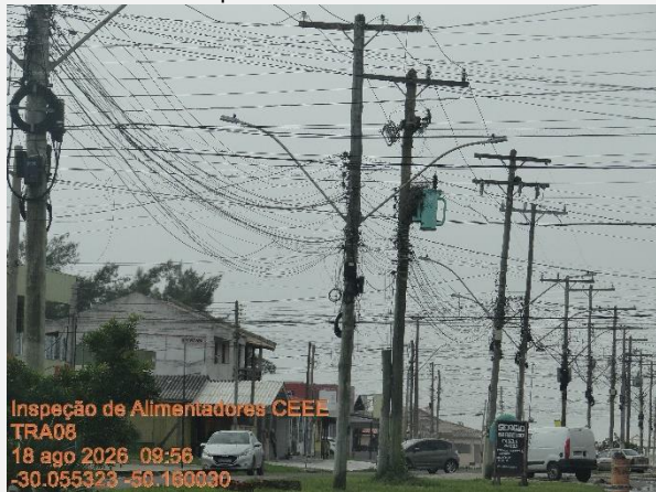
Poste de madeira fora de prumo com escora de madeira e ninho de pássaro em transformador BT.
