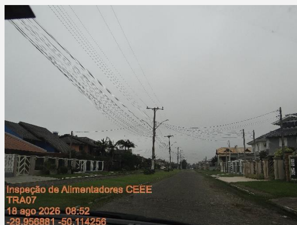
Poste de madeira fora do prumo.
