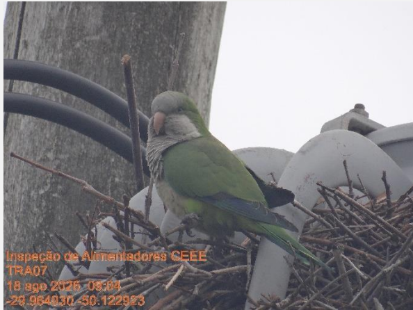
Ninho de pássaro em transformador BT e poste de madeira com escora.
