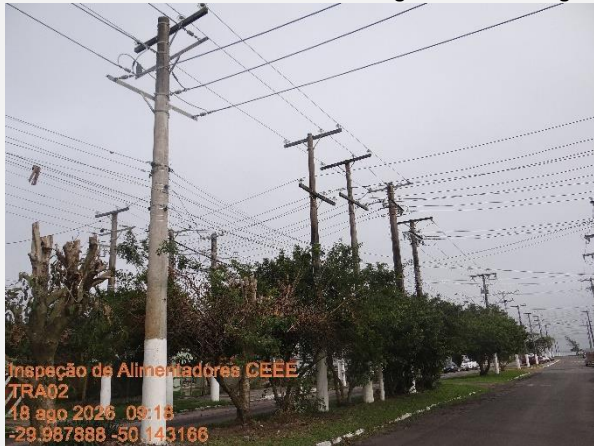
Cabos do alimentador não esticados sugerindo sobrecarga.
