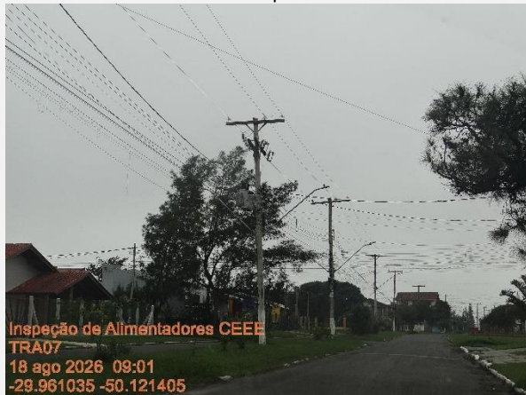
Postes de madeira fora de prumo e com rachaduras.
