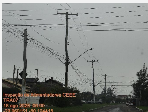
Poste e cruzeta de madeira fora do prumo.
