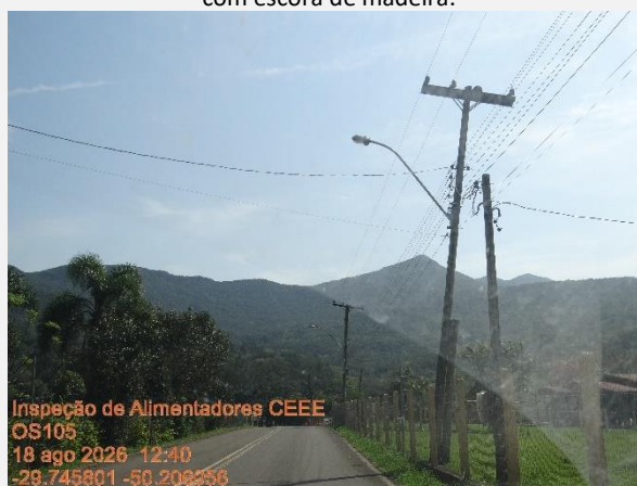
Poste de madeira fora de prumo apresentando rachaduras e com escora de madeira.
