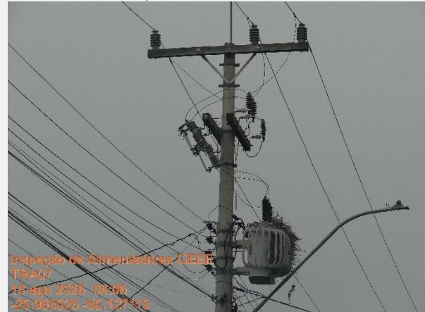
Ninho de pássaro em transformador BT.
