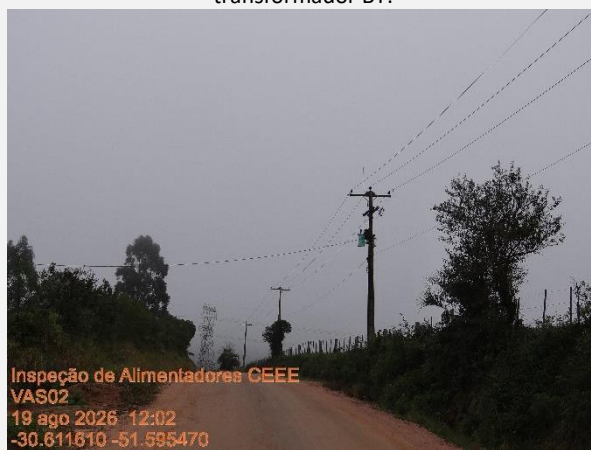
Ninho de pássaro em cruzeta de madeira e em transformador BT.
