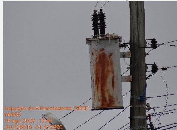
Transformador BT com oxidação.
