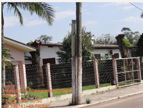
Poste de madeira com transformador BT fora de prumo com escora temporária.
