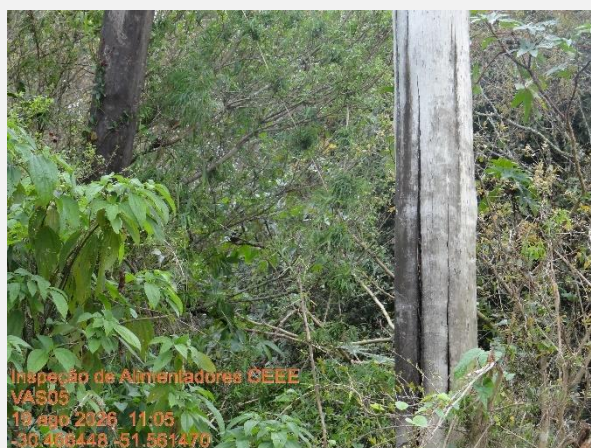
Poste de madeira com rachaduras significativas.
