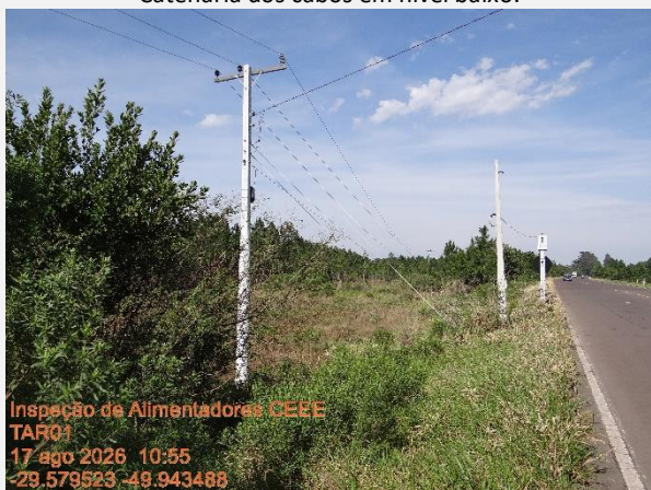
Catenária dos cabos em nível baixo.
