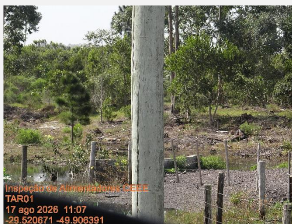
Poste de madeira com rachaduras.
