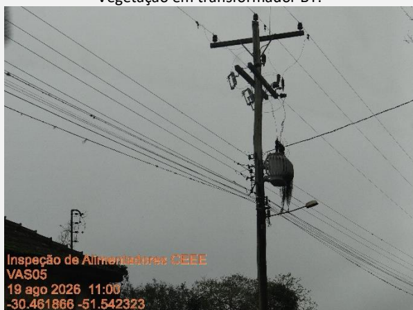
Vegetação em transformador BT.
