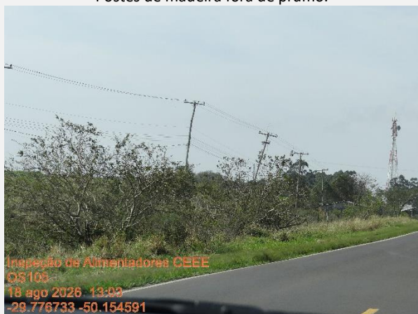
Postes de madeira fora de prumo.
