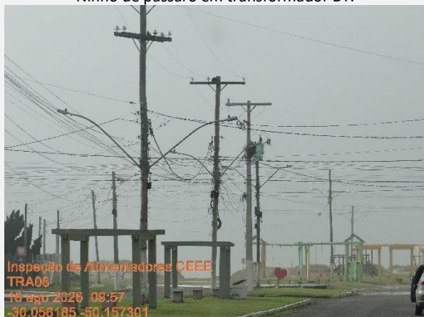
Ninho de pássaro em transformador BT.
