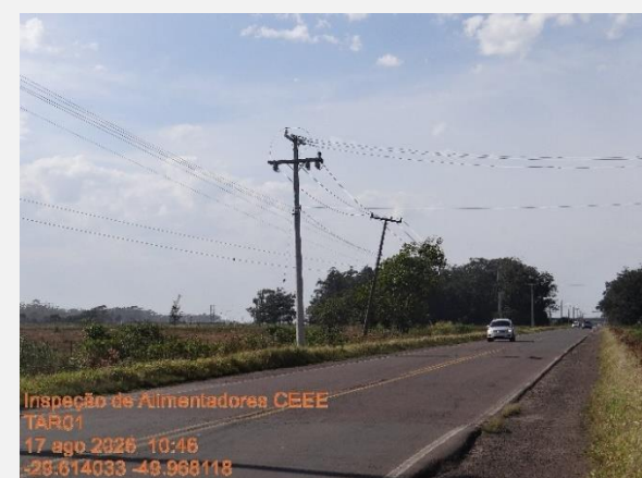
Poste de concreto fora de prumo.
