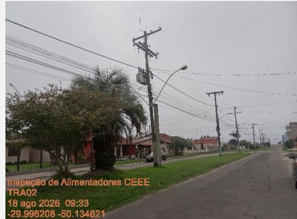
Poste madeira com escora de madeira.
