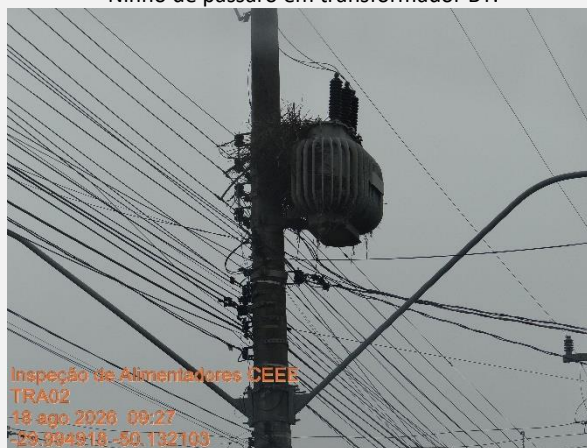
Ninho de pássaro em transformador BT.
