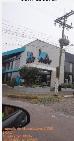
Ninho de pássaro em transformador BT e poste de madeira com escora.
