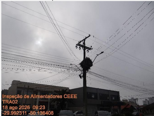
Ninho de pássaro em transformador BT.
