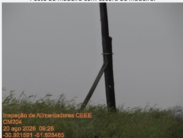
Poste de madeira com escora de madeira.
