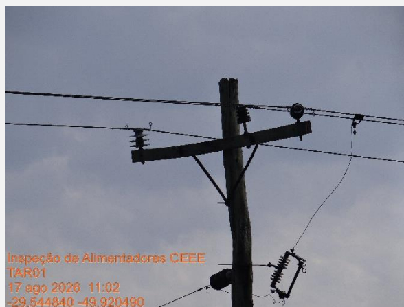
Poste de madeira com rachaduras e isolador fora do pino.
