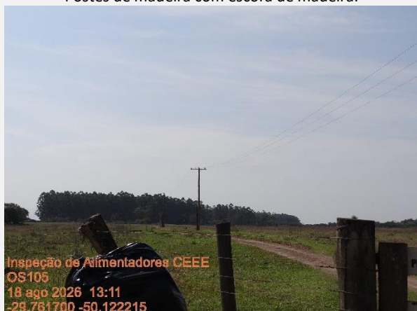
Postes de madeira com escora de madeira.
