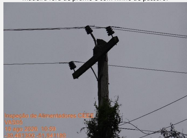
Poste de madeira tomado por vegetação, com cruzeta de madeira fora de prumo e com ninho de pássaro.
