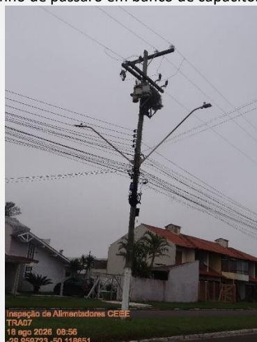
Ninho de pássaro em banco de capacitores.
