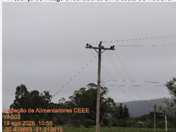
Presença de musgo e rachaduras em cruzeta de madeira.
