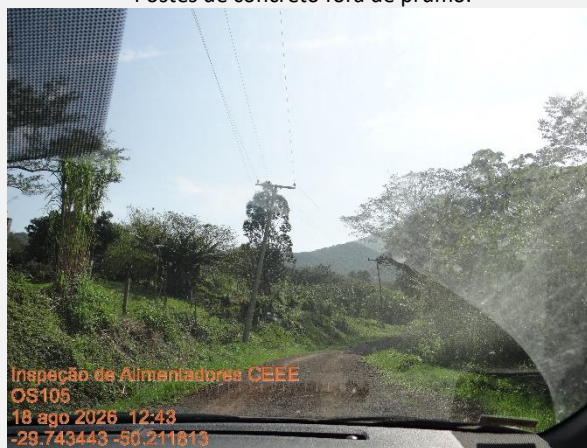
Postes de concreto fora de prumo.
