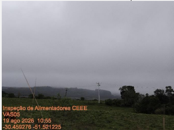
Postes de fibra e de madeira fora de prumo.
