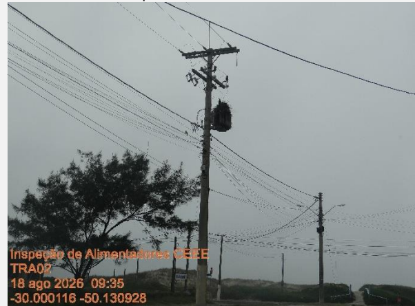
Ninho de pássaro em transformador BT.
