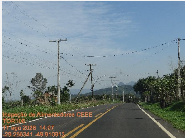
Poste de madeira apresentando rachaduras e ninho de pássaro sobre cruzeta de madeira.
