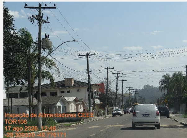
Postes de concreto fora de prumo.
