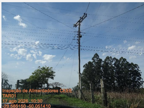
Cruzeta de madeira com rachaduras e poste de madeira com escora temporária.
