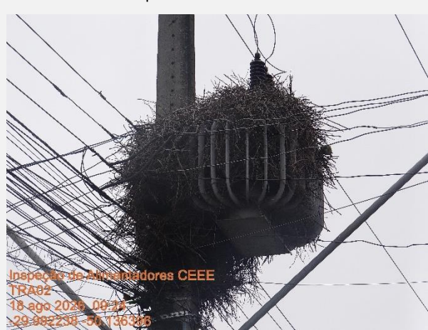
Ninho de pássaro em transformador BT.
