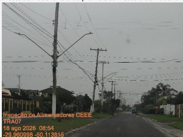
Poste de madeira fora do prumo e com escora de madeira.
