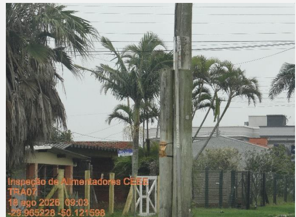
Poste de madeira com transformador BT sustentado por escora de madeira.
