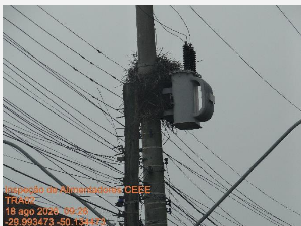
Ninho de pássaro em transformador BT.
