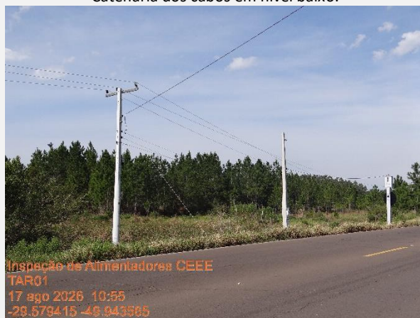
Catenária dos cabos em nível baixo.
