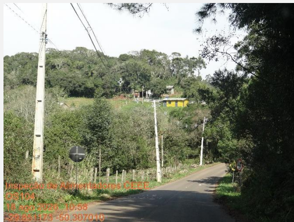
Postes de concreto fora de prumo.
