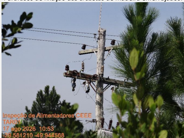
Parafusos de fixação das cruzetas de madeira enferrujados.
