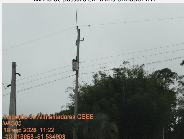
Ninho de pássaro em transformador BT.
