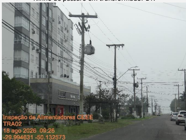
Ninho de pássaro em transformador BT.
