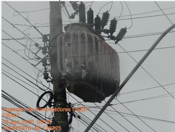
Ninho de pássaro em transformador BT.
