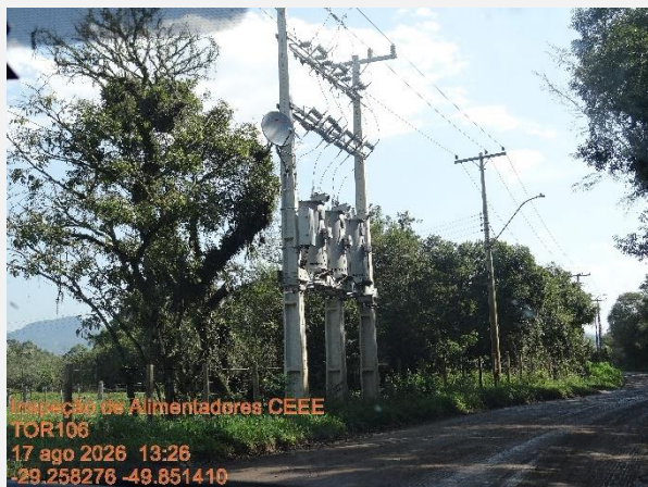
Vegetação próxima aos cabos do alimentador.
