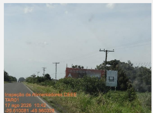
Falta de limpeza de faixa do alimentador.
