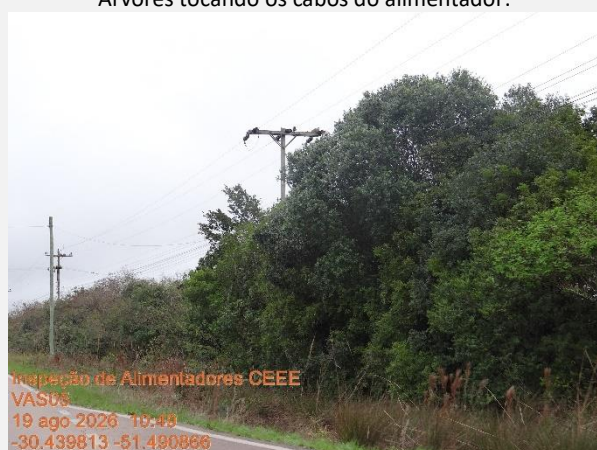
Árvores tocando os cabos do alimentador.
