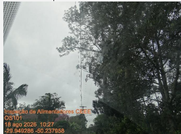
Árvores próxima aos cabos do alimentador.
