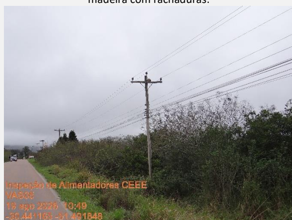
Ninho de pássaro em cruzeta de madeira e poste de madeira com rachaduras.
