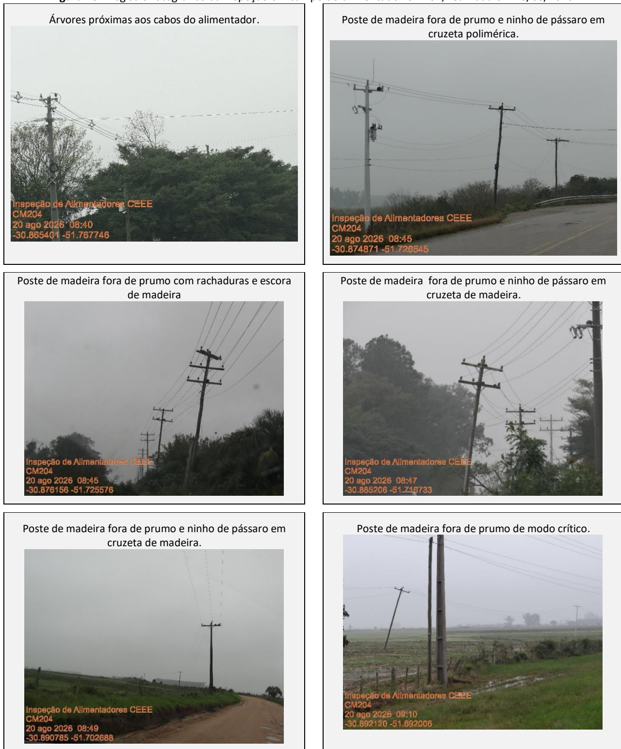
Figura 18 - Registro fotográfico da inspeção em campo do alimentador CM204, realizada em 20/08/2026.
