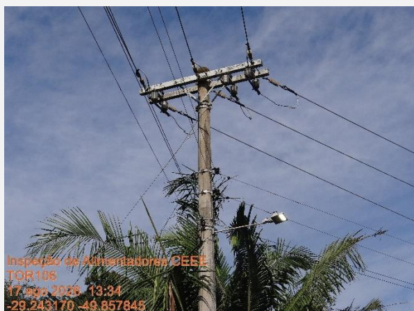
Ninho de pássaro sobre topo de poste de concreto.
