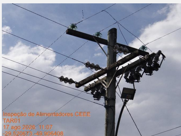
Cruzeta de madeira apresentando rachaduras.
