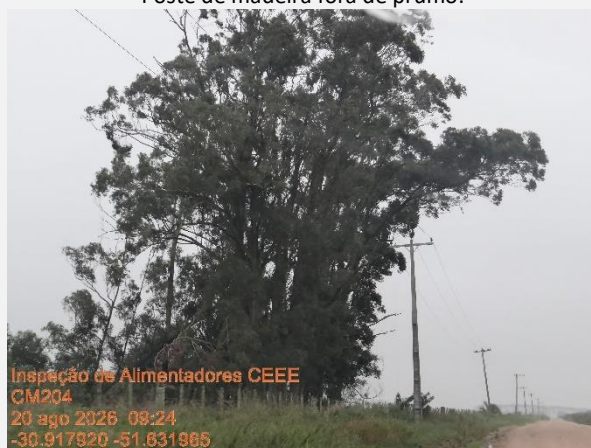
Poste de madeira fora de prumo.
