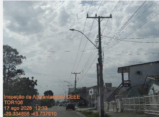
Postes de concreto fora de prumo.
