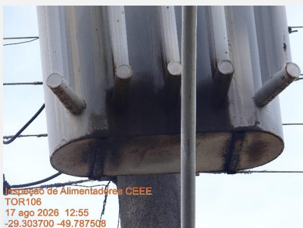
Transformador BT com indícios de vazamento de óleo.
