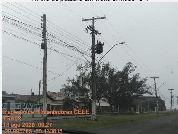
Ninho de pássaro em transformador BT.
