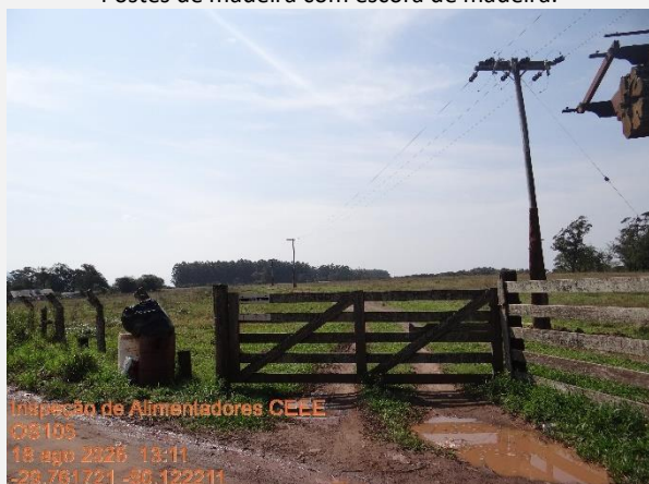
Postes de madeira com escora de madeira.
