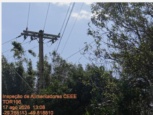
Vegetação próxima aos cabos do alimentador.
