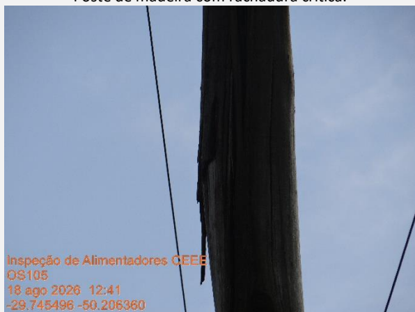
Poste de madeira com rachadura crítica.
