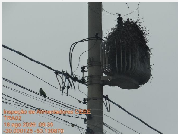
Ninho de pássaro em transformador BT.
