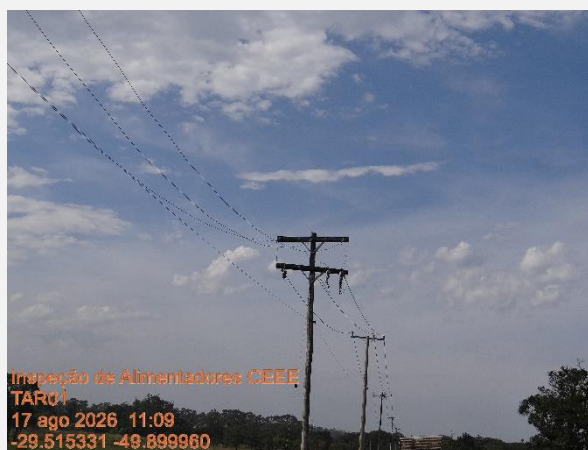
Poste de madeira fora de prumo, cruzeta desnivelada e cabos não esticados sugerindo sobrecarga.
