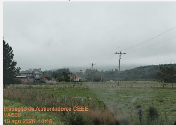
Ninho de pássaro em cruzeta de madeira e poste de madeira fora de prumo com escora de madeira.
