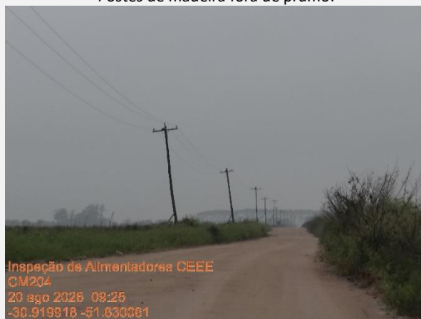
Postes de madeira fora de prumo.
