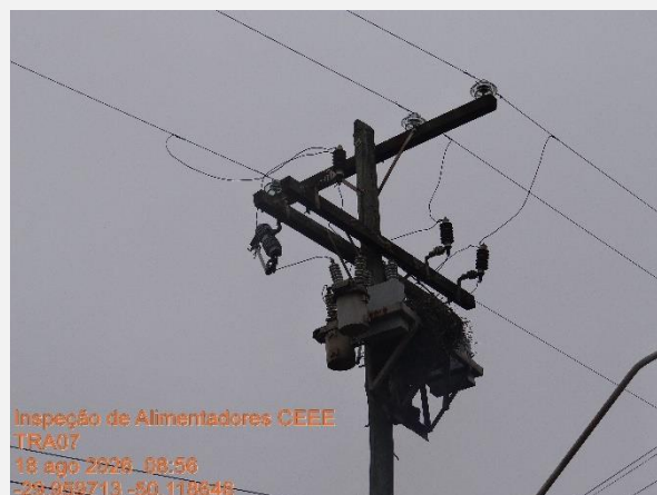
Ninho de pássaro em banco de capacitores.
