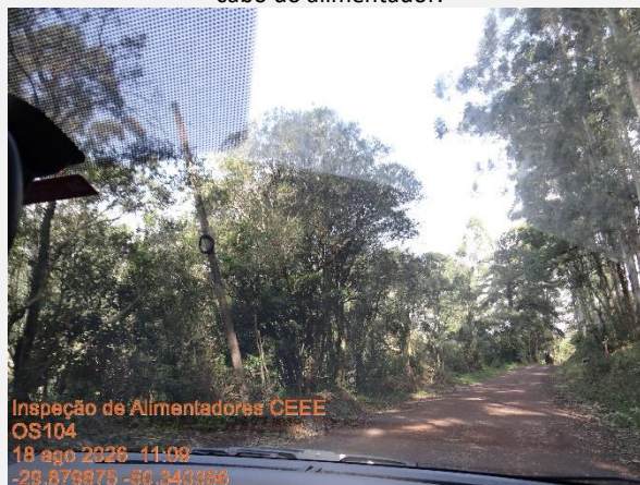
Poste de madeira fora de prumo e vegetação próxima ao cabo do alimentador.
