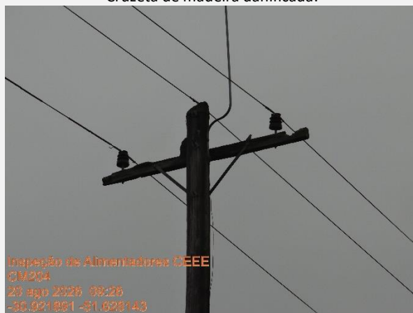
Cruzeta de madeira danificada.
