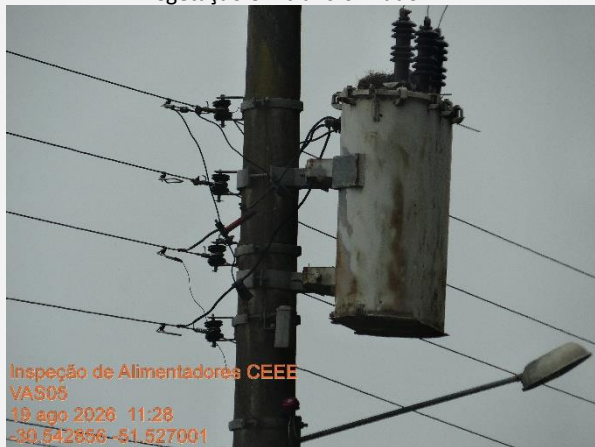
Vegetação em transformador BT.
