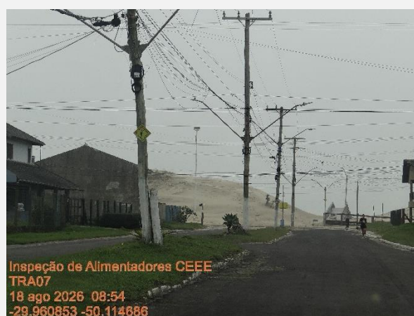
Poste de madeira fora do prumo e com escora de madeira.
