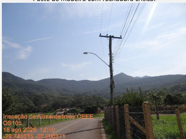
Poste de madeira com rachadura crítica.
