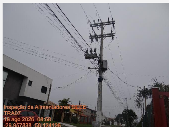
Ninho de pássaro no quadro de comando da chave telecontrolada.
