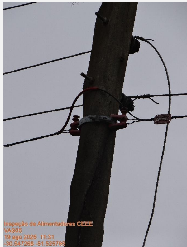
Cabo de baixa tensão rompido, representando risco aos transeuntes.
