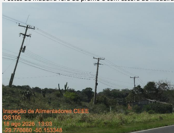
Postes de madeira fora de prumo e com escora de madeira.
