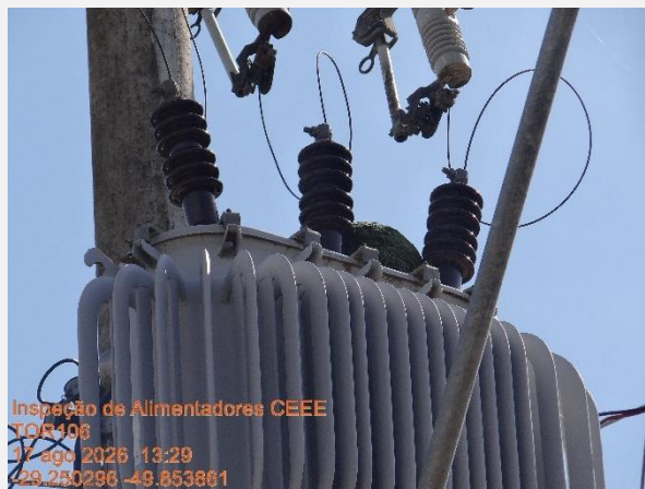
Ninho de pássaro sobre transformador BT.
