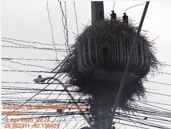
Ninho de pássaro em transformador BT.
