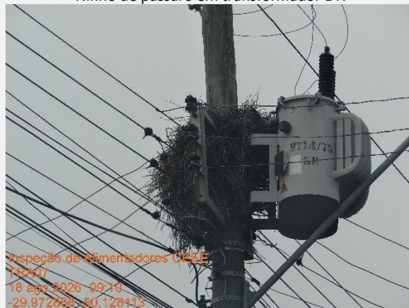
Ninho de pássaro em transformador BT.
