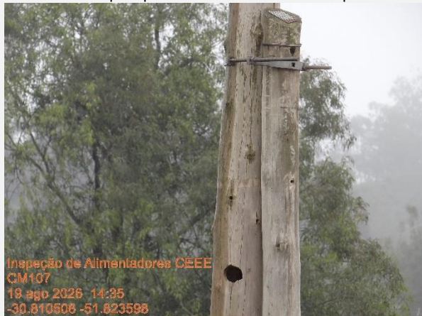
Ninho de pica-pau e escora de madeira em poste.
