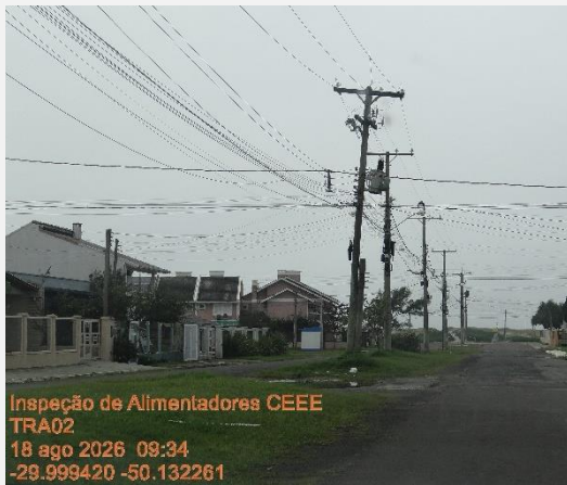
Poste de madeira com transformador BT fora de prumo com escora de madeira.
