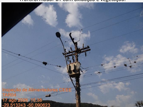
Transformador BT com oxidação e vegetação.
