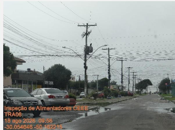
Poste com escora de madeira e ninho de pássaro em transformador BT.
