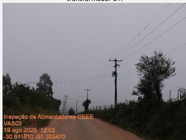
Ninho de pássaro em cruzeta de madeira e em transformador BT.
