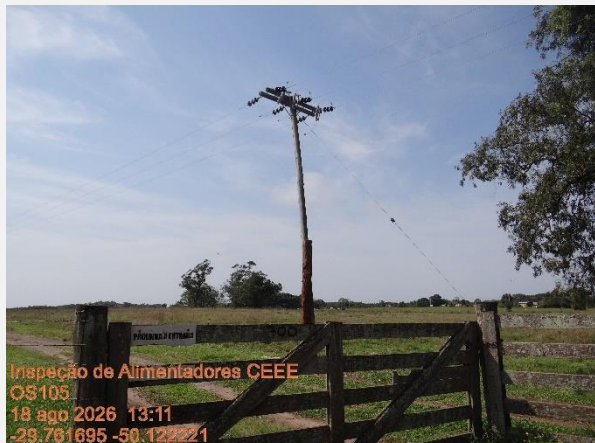
Postes de madeira com escora de madeira.
