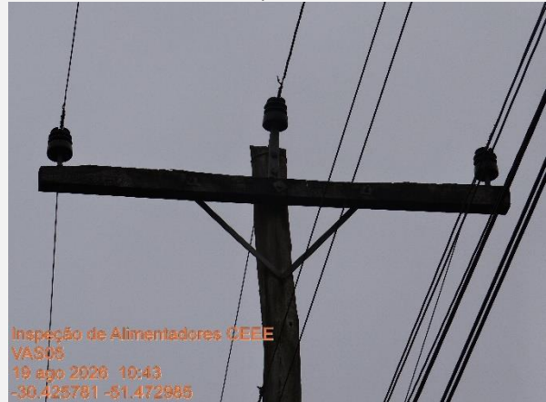
Cruzeta de madeira apresentando rachaduras.
