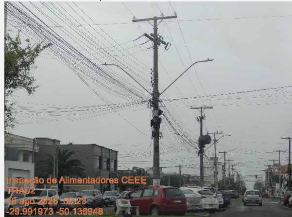
Ninho de pássaro em transformador BT.
