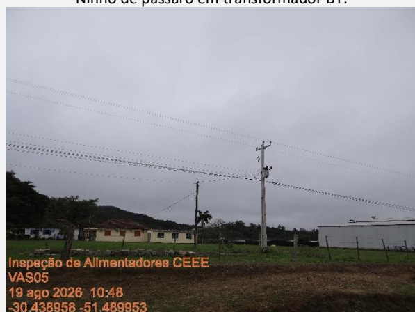
Ninho de pássaro em transformador BT.
