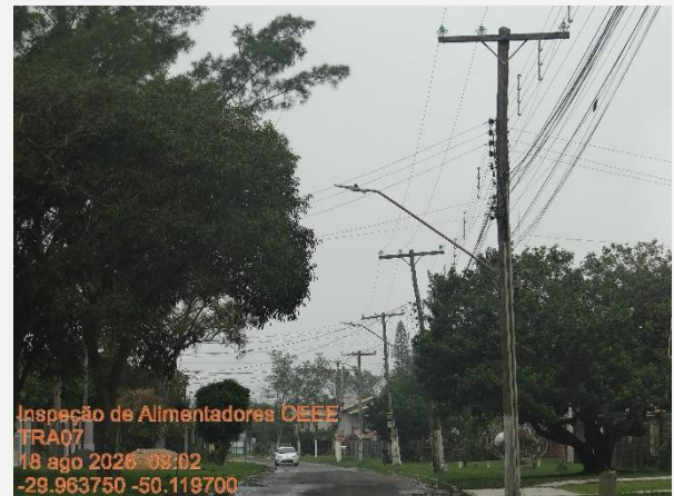
Postes de madeira fora de prumo e com escoras de madeira.
