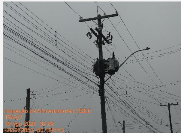
Ninho de pássaro em transformador BT.
