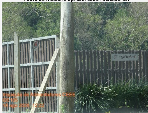
Poste de madeira apresentado rachaduras.
