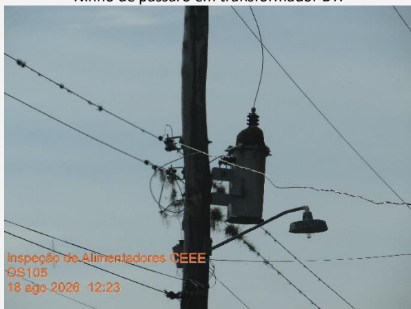
Ninho de pássaro em transformador BT.
