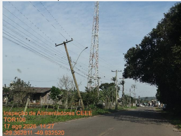
Poste de madeira fora de prumo de maneira crítica e apresentando rachaduras.
