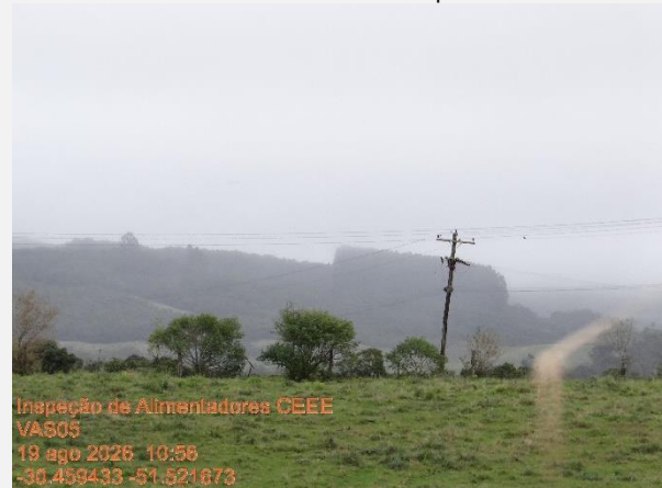
Poste de madeira fora de prumo.
