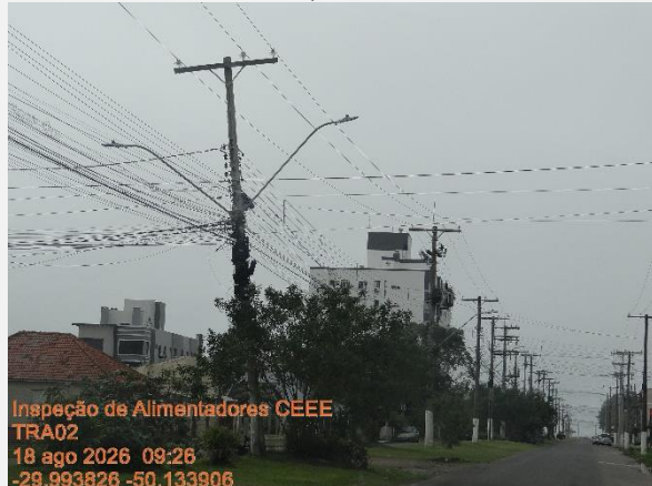
Poste de concreto fora de prumo com escora de madeira.
