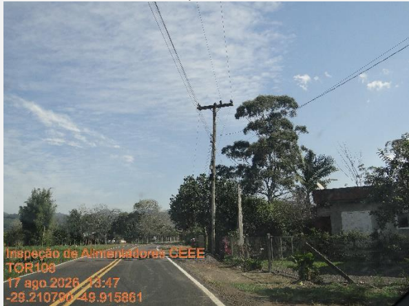
Poste de madeira apresentando rachaduras.
