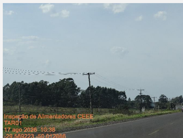
Poste de madeira fora de prumo.
