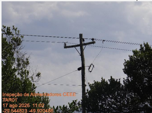
Poste de madeira com rachaduras e isolador fora do pino.
