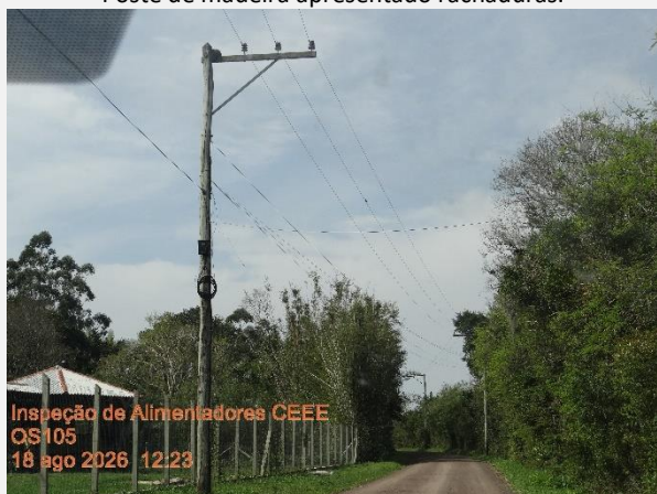
Poste de madeira apresentado rachaduras.
