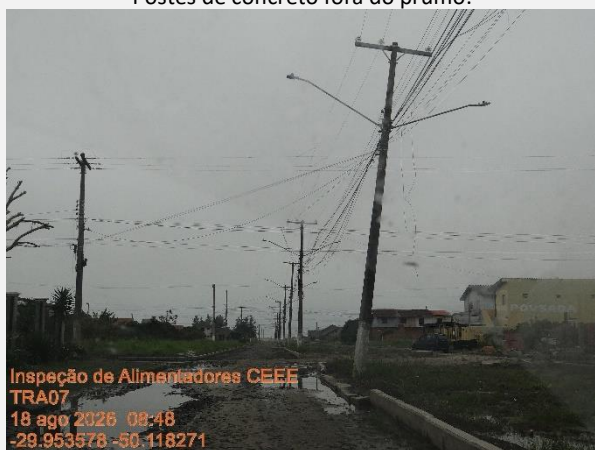
Postes de concreto fora do prumo.
