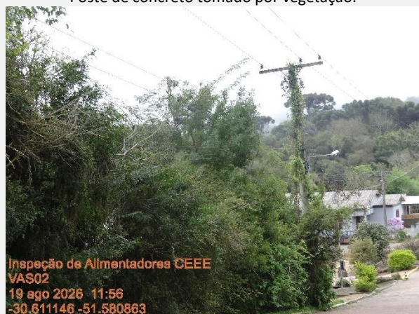
Poste de concreto tomado por vegetação.
