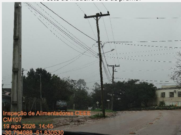
Poste de madeira fora de prumo.
