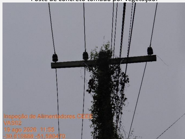
Poste de concreto tomado por vegetação.
