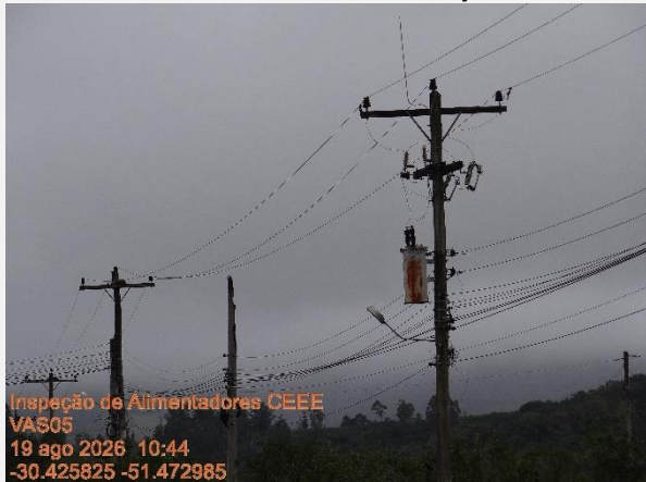
Transformador BT com oxidação.
