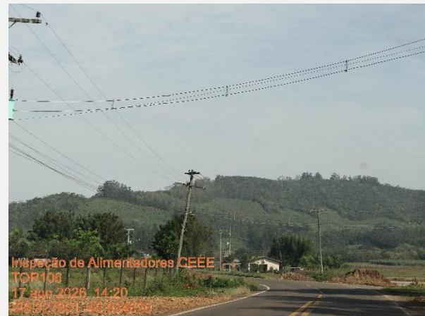
Postes de madeira fora de prumo.
