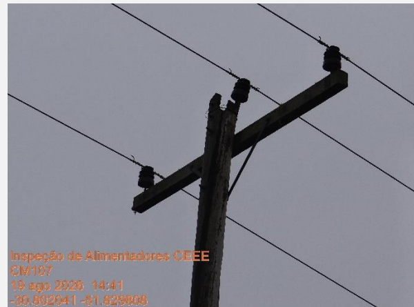
Topo de poste de madeira quebrado com rachaduras e isolador do cabo do alimentador desafixado.
