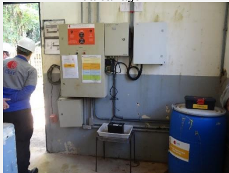
Quadro de comando e unidade de telemetria da barragem.
