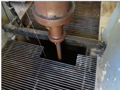
Sistema de hidráulico.
