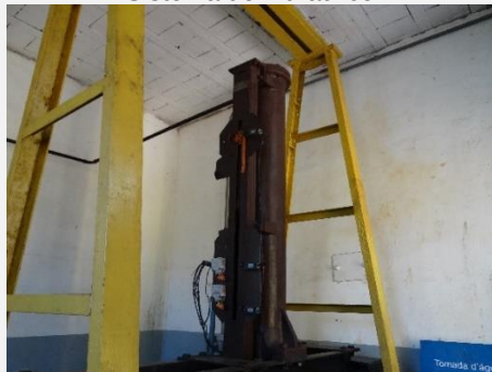
Sistema de hidráulico.
