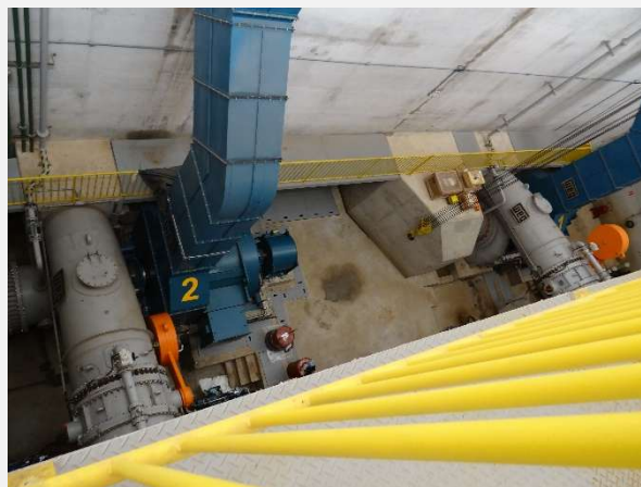
Casa de Máquinas da PCH Quebra Dentes.
