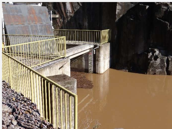
Tomada d'água da PCH Quebra Dentes.
