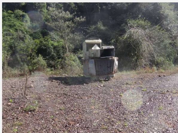
Transformador da casa de máquinas auxiliar avariado nas cheias de 2024.
