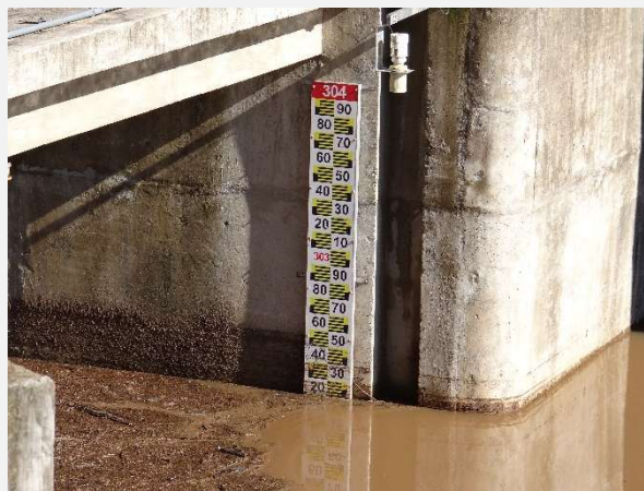
Tomada d'água da PCH Quebra Dentes.
