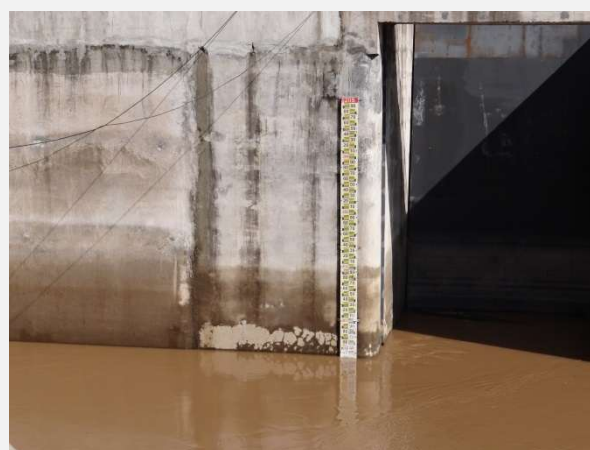
Régua de Nível na Tomada D'água da PCH Cachoeira Cinco Veados.
