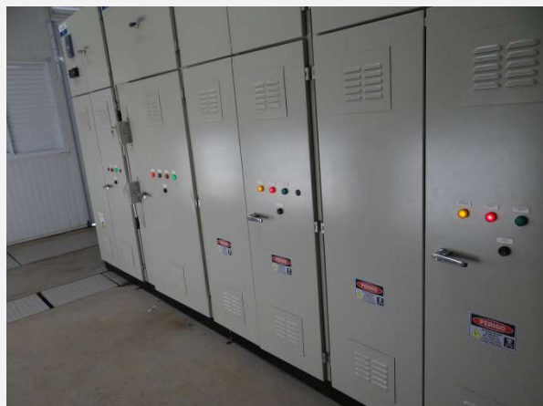
Sala de Cubículos da PCH Cachoeira Cinco Veados.
