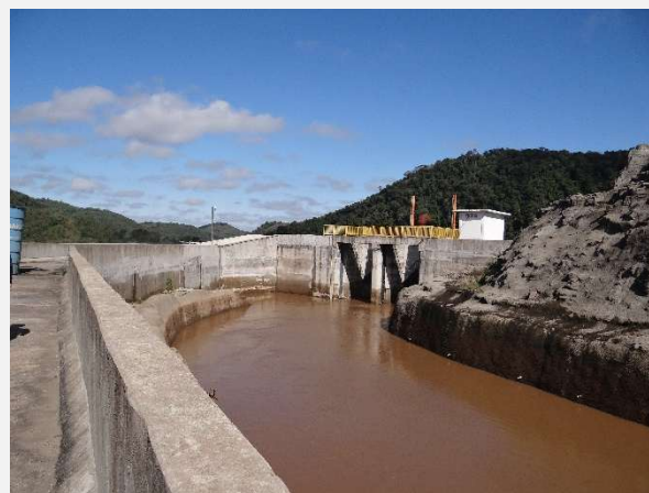
Canal de Adução e tomada d'água.
