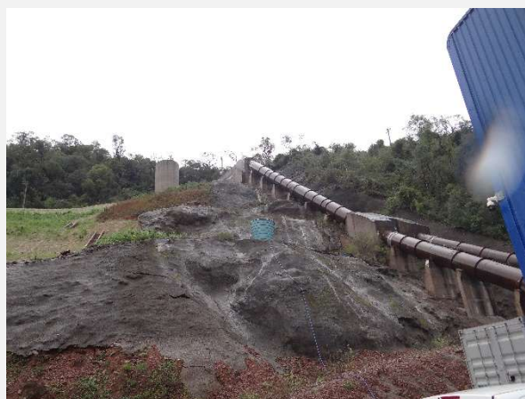
Condutos forçados da PCH Salto do Guassupi.
