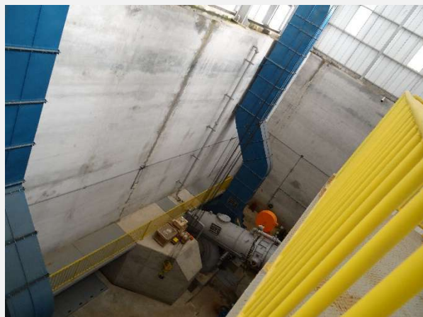
Casa de Máquinas da PCH Quebra Dentes.
