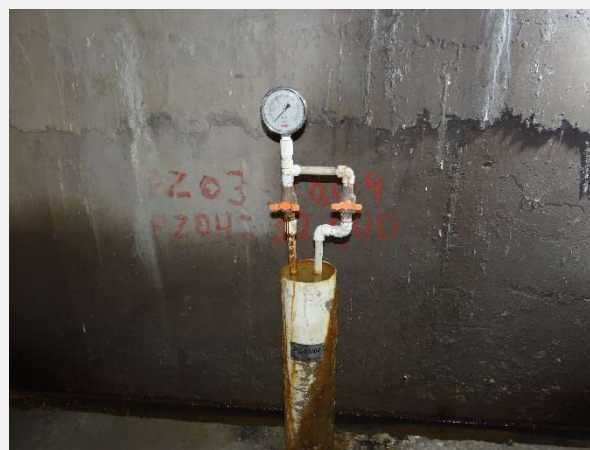
Galeria de Drenagem da Barragem - Piezômetros com manômetros inoperantes.
