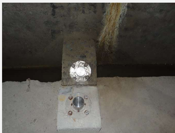
Galeria de Drenagem da Barragem - Extensômetro.
