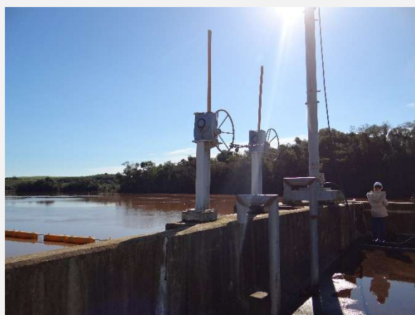
Mecanismos de manobra da descarga de fundo da vazão sanitária.
