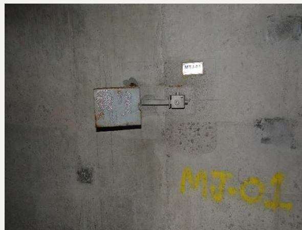
Galeria de Drenagem da Barragem - Medidor Triortogonal.
