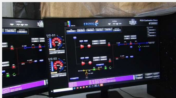
Sala de Controle da PCH Cachoeira Cinco Veados.
