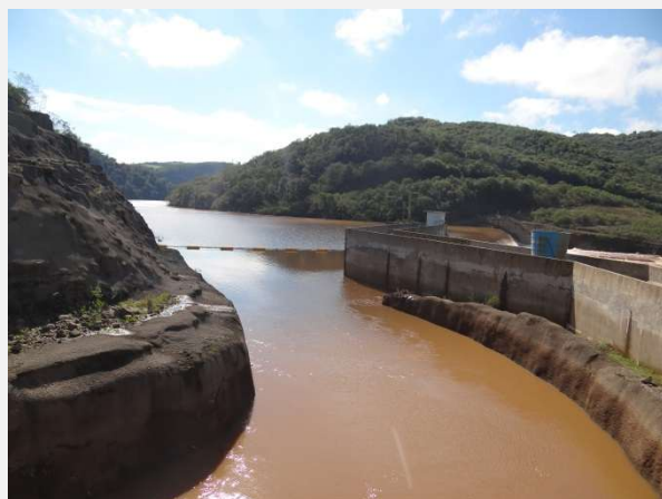
Canal de Adução da PCH Cachoeira Cinco Veados.
