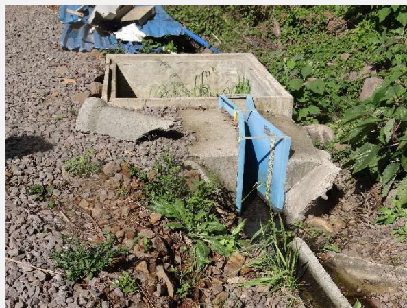
Medidor de vazão, avariado pelos eventos de maio de 2024 na PCH Cachoeira Cinco Veados.
